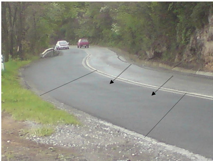
Σχήμα 6.7: Οδόστρωμα πρόσφατα επιστρωμένο με νέο τάπητα κυκλοφορίας λόγω της χαμηλής αντίστασης ολίσθησης / Παρατηρείται ήδη ανεπαρκής ομαλότητα οδοστρώματος
