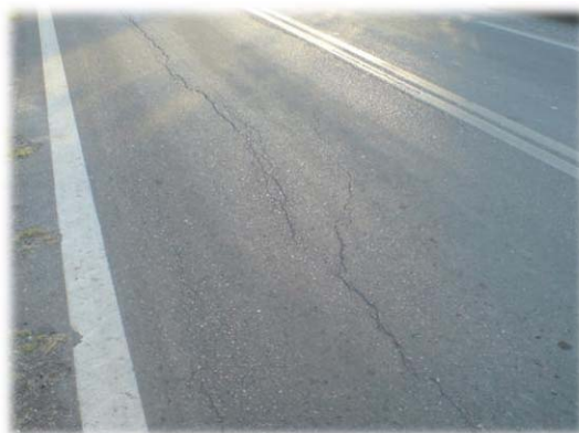
Φωτογραφία 8.2β: Μέτρια φθορά: τροχοαυλάκωση και ρηγματώσεις
