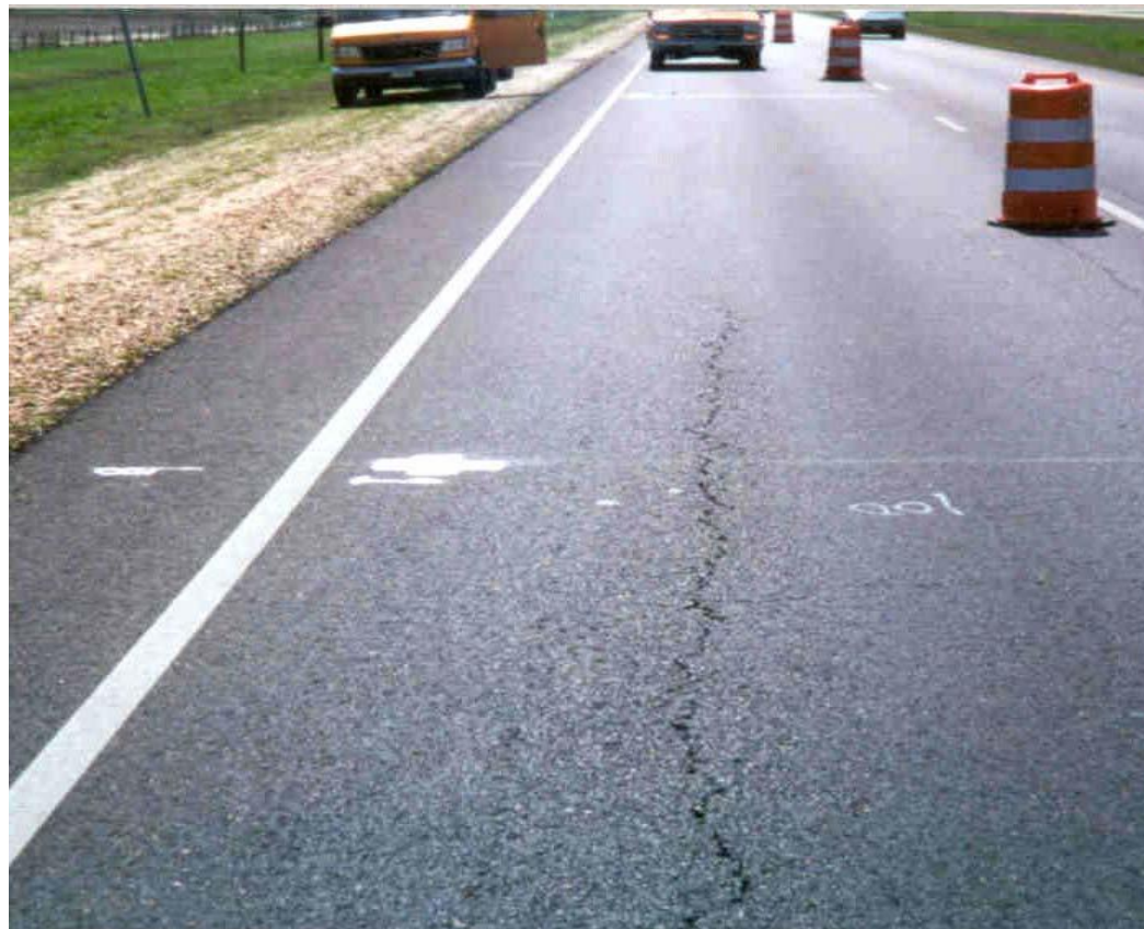
Σχήμα 4.4: Παράδειγμα κατά μήκος ρηγμάτωσης σε εύκαμπτο οδόστρωμα
