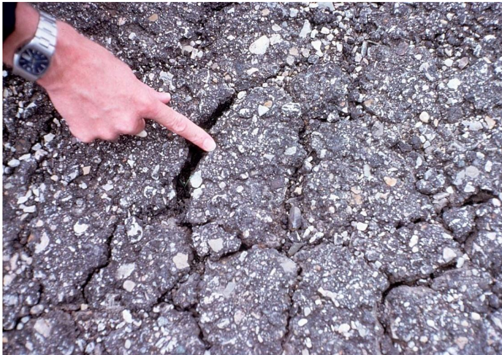
Σχήμα 4.2: Παράδειγμα ρηγματώσεων κόπωσης σε εύκαμπτο οδόστρωμα
