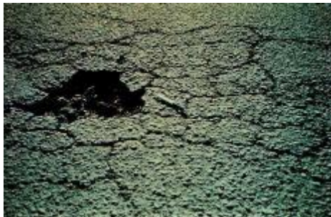
Λακούβα από ρηγματώσεις κόπωσης
