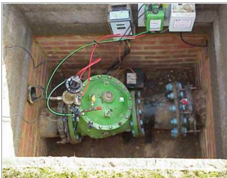
Εικόνα 4.1 Μια εγκατεστημένη βαλβίδα μείωσης της πίεσης
