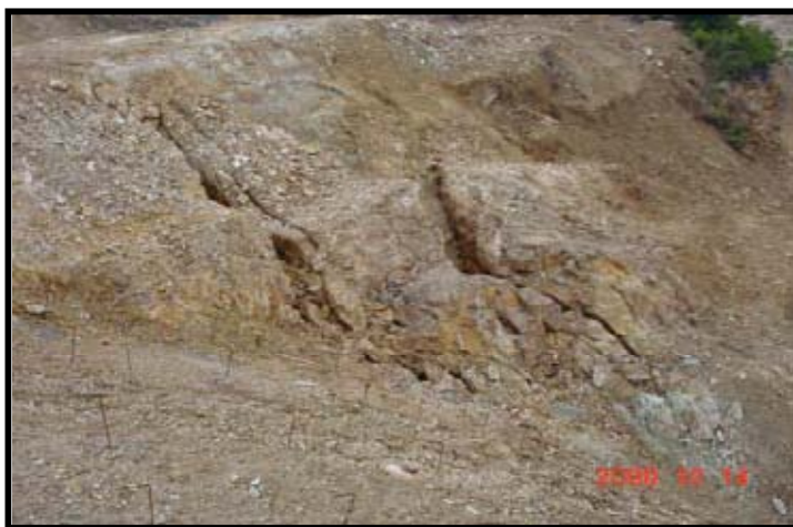
Εικόνες 9 – 1: Αστοχία κατά την εκσκαφή του εκχειλιστή (Θανόπουλος Ι., 2006)
