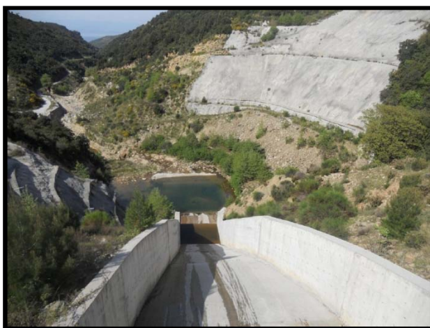
Εικόνα 9 - 4 : Διώρυγα εκχειλιστή και διαβρωμένη επιφάνεια πρόσπτωσης (Πηγή: http://www.panoramio.com )
