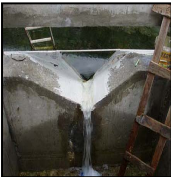
Εικόνα 7 – 8: Εκχειλιστής μέτρησης διαρροών στον πόδα του φράγματος (Πηγή: Θανόπουλος Ι., 2006)
