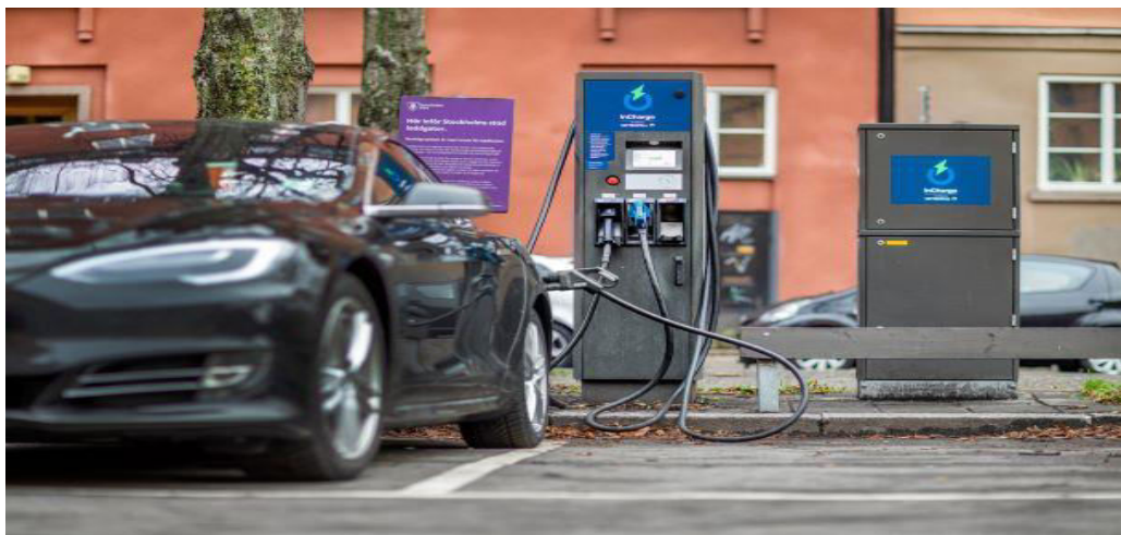
Εικόνα 4.5 : Κοινόχρηστη παροχή φόρτισης ηλεκτρικού οχήματος της εταιρίας ABB [99]
