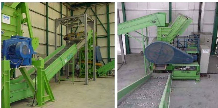
Εικόνα 6.1: Μηχανολογικός εξοπλισμός της μονάδας επεξεργασίας ΑΗΗΕ (ΕΚΑΝ)
