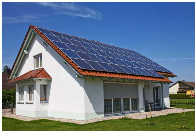
Εικόνα 6.14: Φωτοβολταϊκό σε στέγη
