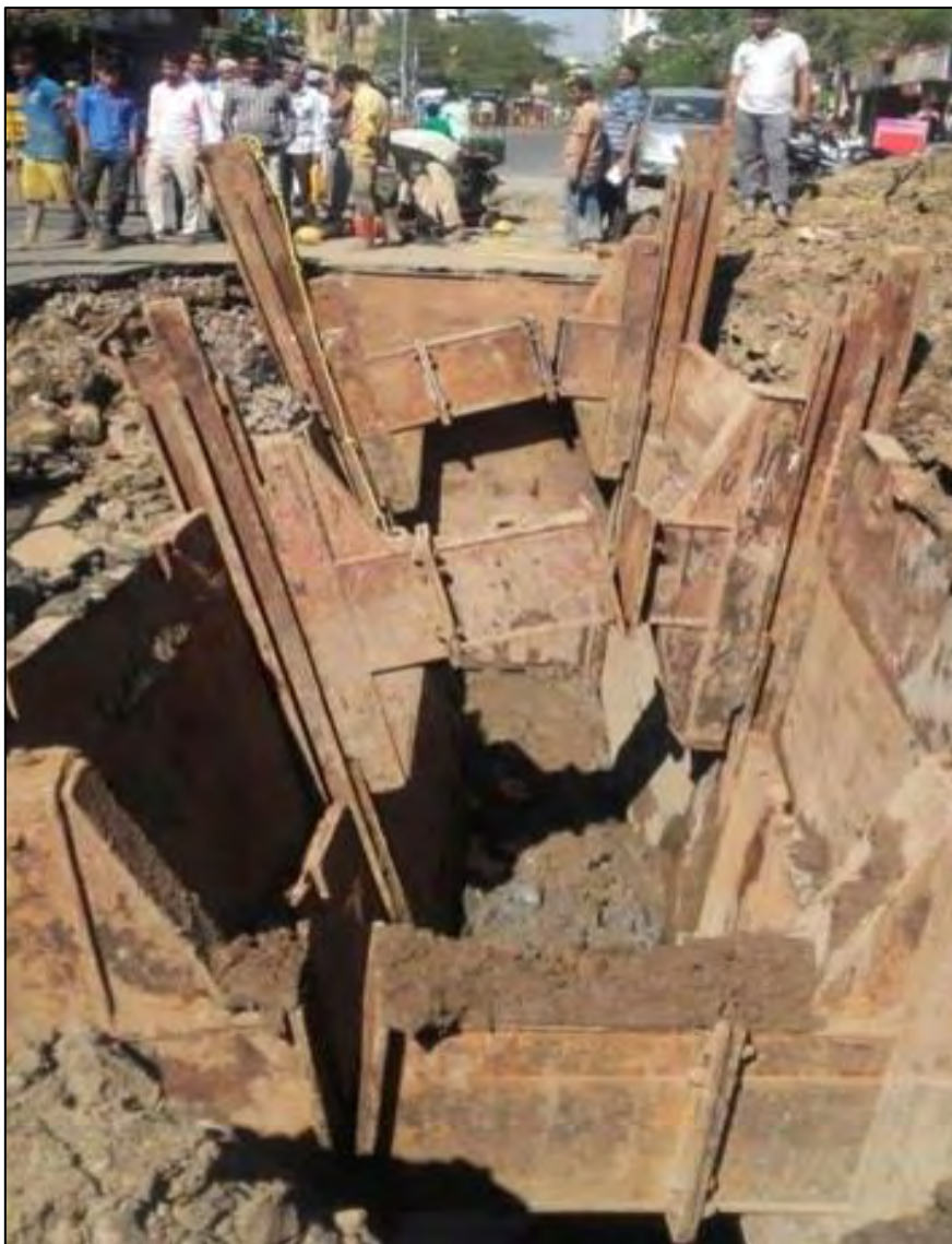
Εικόνα 49: Αστοχία-κατάρρευση αντιστήριξης σε όρυγμα αποχέτευσης, www.shoring.de
