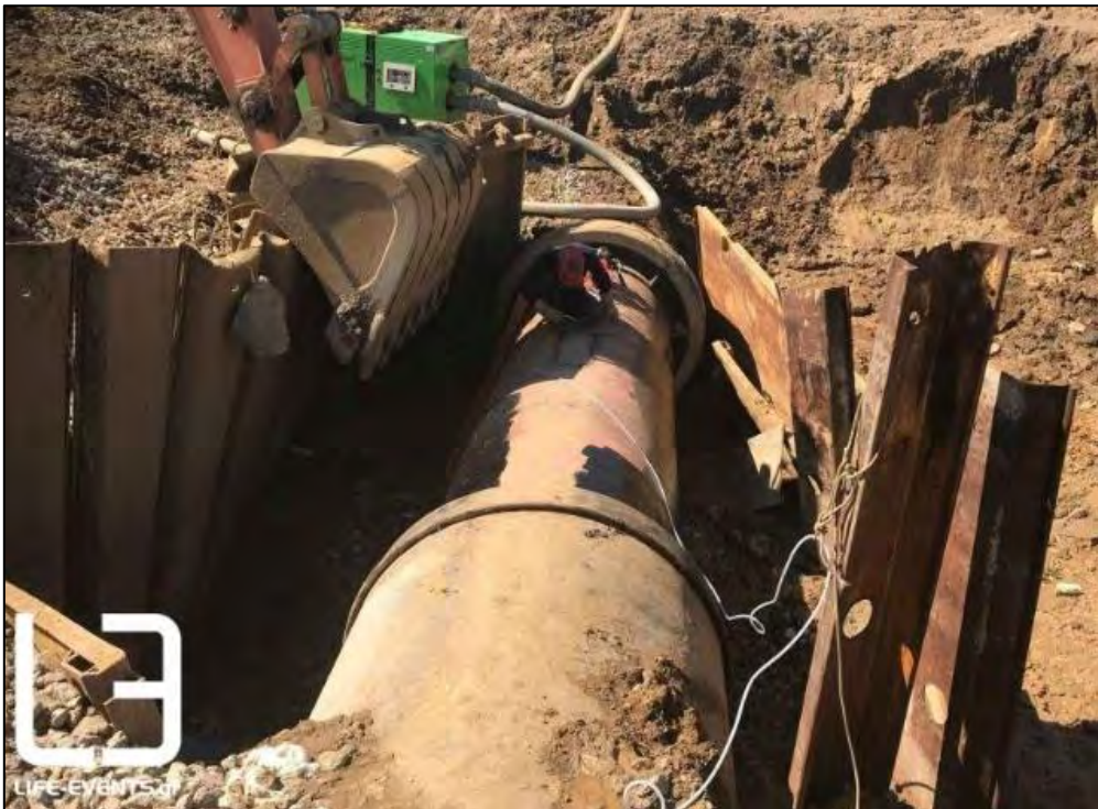
Εικόνα 59: Αστοχία αντιστήριξης, λυγισμός πασσαλοσανίδων, ανεπαρκής βάθος έμψηξης, Θεσσαλονίκη, αρχείο Ε.Υ.Α.Θ
