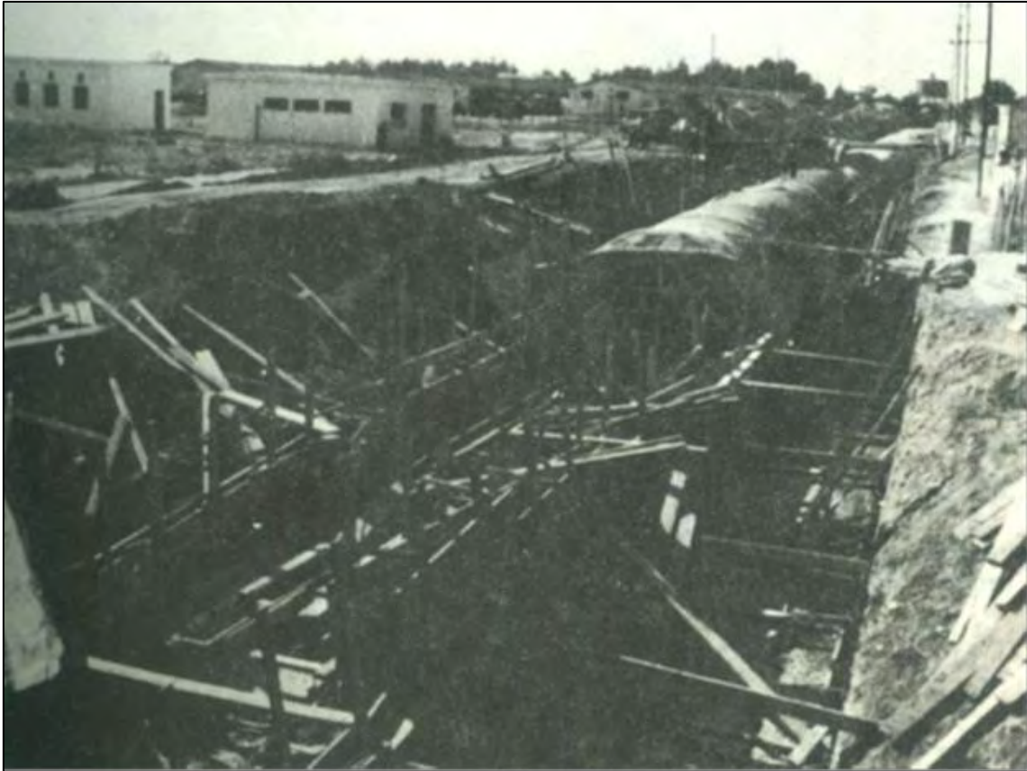
Εικόνα 23: Κατασκευή κεντρικού αποχετευτικού αγωγού με χρήση αντιστήριξης ξύλινων πασσαλοσανίδων, Λάρισα 1968, (φωτ. Τάκης Γλούπας, αρχείο Δ.Ε.Υ.Α.Λ)
