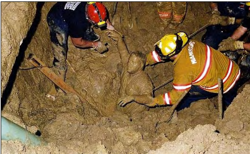
Εικόνα 57: Αστοχία διαφράγματος, απεγκλωβισμός εργαζομένου, Η.Π.Α
