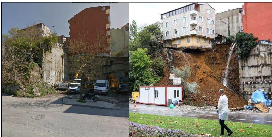
Εικόνα 54: Αστοχία αντιστήριξης διαφράγματος, Κωνσταντινούπολη 2018, (hurrietarydailynews.com)
