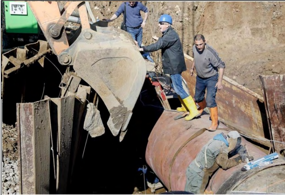
Εικόνα 58: Αστοχία αντιστήριξης πασσαλοσανίδων, ανεπαρκής βάθος έμψηξης, δομική αστοχία, Θεσσαλονίκη, αρχείο Ε.Υ.Α.Θ
