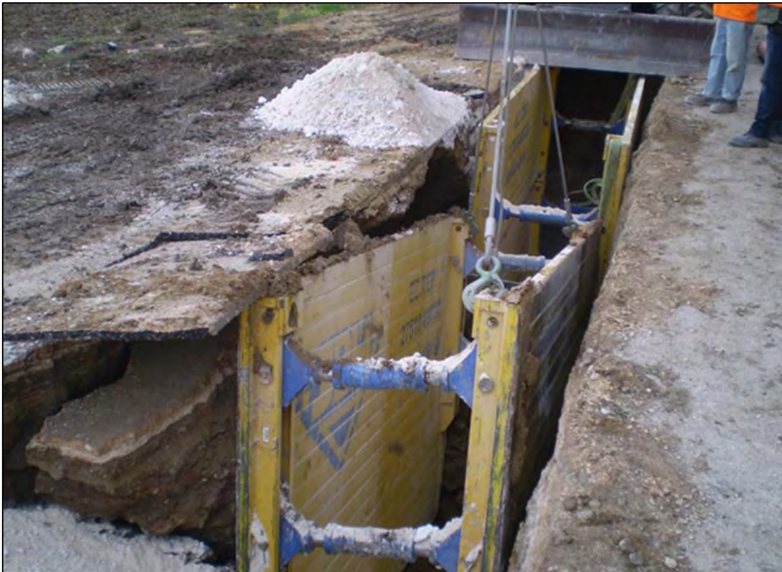
Εικόνα 20: Κακός υπολογισμός αφαίρεσης μονάδας αντιστήριξης-κατάπτωση πρανών, Λάρισα 2014, αρχείο ΔΕΥΑΛ
