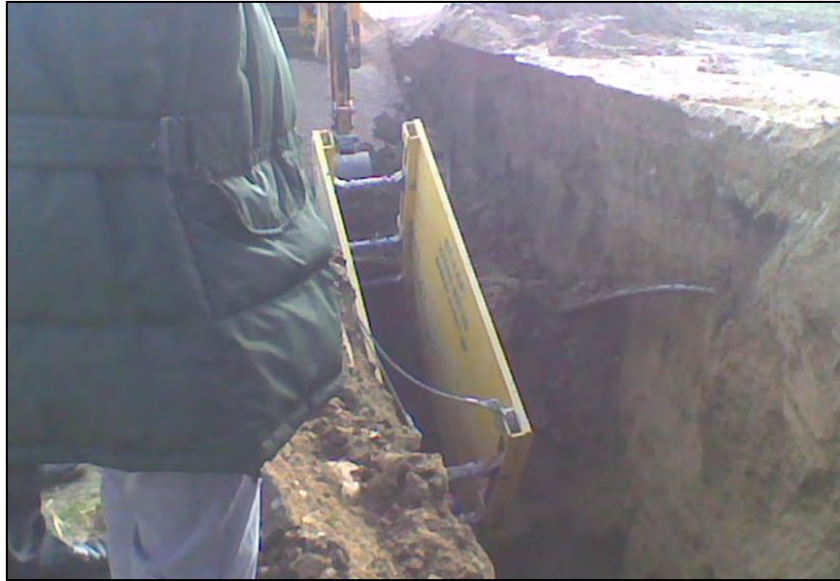
Εικόνα 50: Καταπτώσεις σε όρυγμα αποχέτευσης, Λάρισα 2013, αστοχία αντιστήριξης λόγω υπερεκσκαφής (αρχείο Δ.Ε.Υ.Α.Λ)
