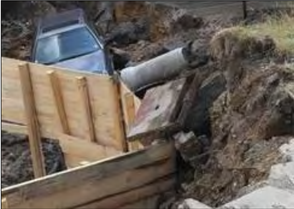
Εικόνα 56: Δομική αστοχία διαφράγματος σε δίκτυο ομβρίων, nika-tc.com
