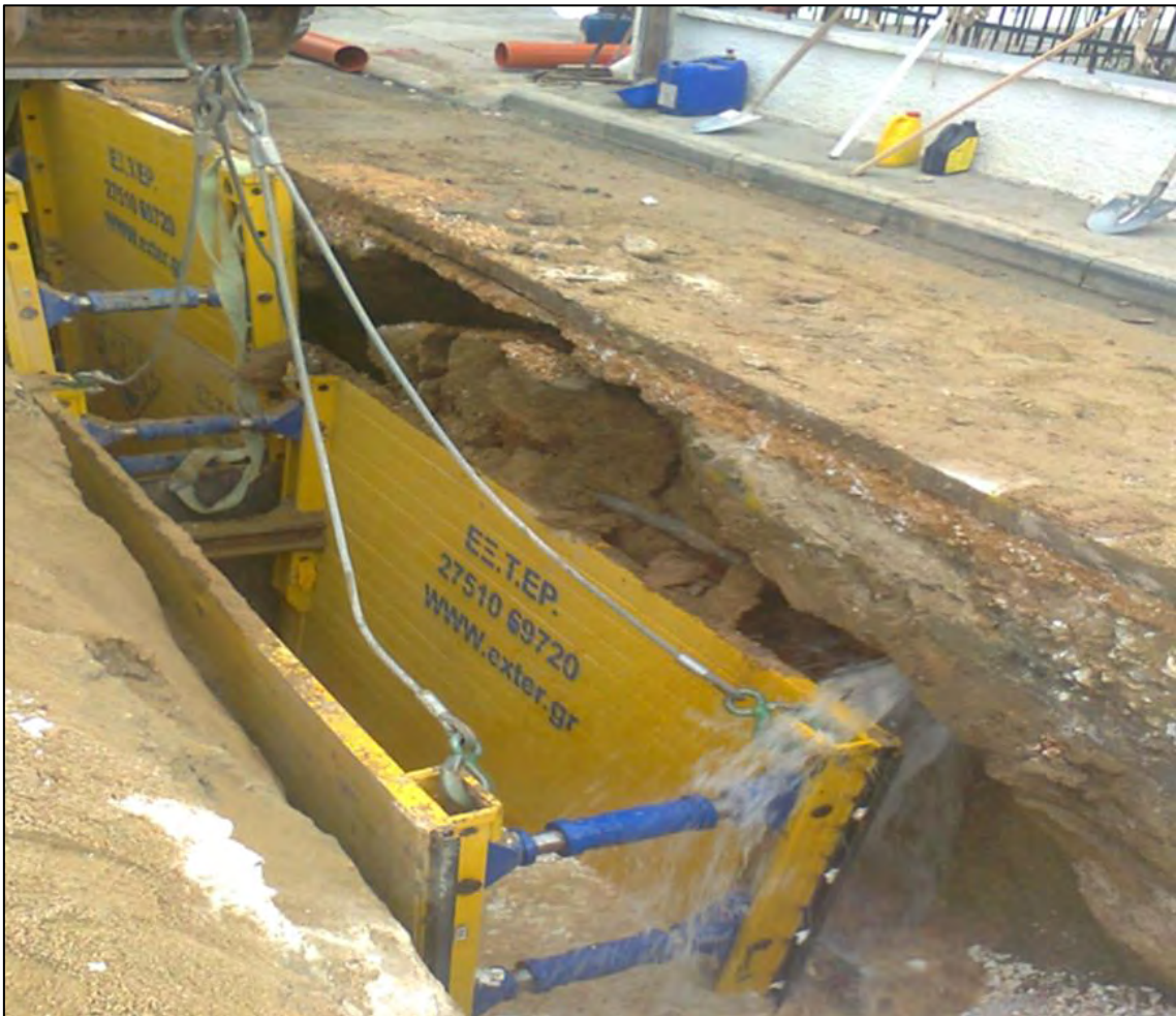
Εικόνα 52: Αστοχία αντιστήριξης λόγω γενικότερης αστάθειας του συστήματος, απουσία έμπηξης, έλλειψη διπλού πρόσθετου πανέλου καθ' ύψος, με κατάπτωση πρανούς και εισροή νερού από βλάβη σε αγωγό ύδρευσης, Λάρισα 2014, αρχείο Δ.Ε.Υ.Α.Λ.
