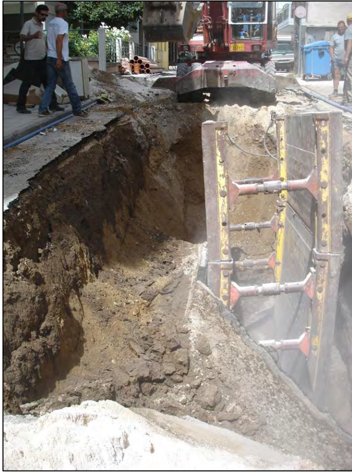
Εικόνα 5: Κατάπτωση πρανούς σε όρυγμα αποχέτευσης, οδός Σαλαμίνας, Λάρισα 2010, αρχείο Δ.Ε.Υ.Α.Λ
