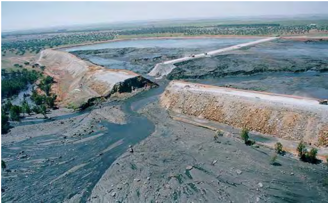
Εικόνα 2.2: Κατάρρευση φράγματος στο Aznacollar
