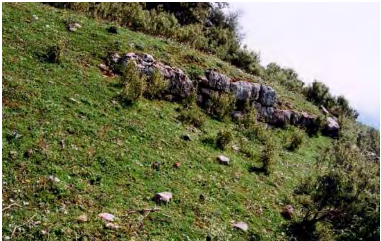
Εικ. 538/299. Πάος (παλ. τοπων. Σκούπι) Καλαβρύτων, θέση Σκουπίτσι, ή Σκουπίτσα. Αναλημματικός τοίχος στη νότια πλευρά του λόφου, από ΝΔ
