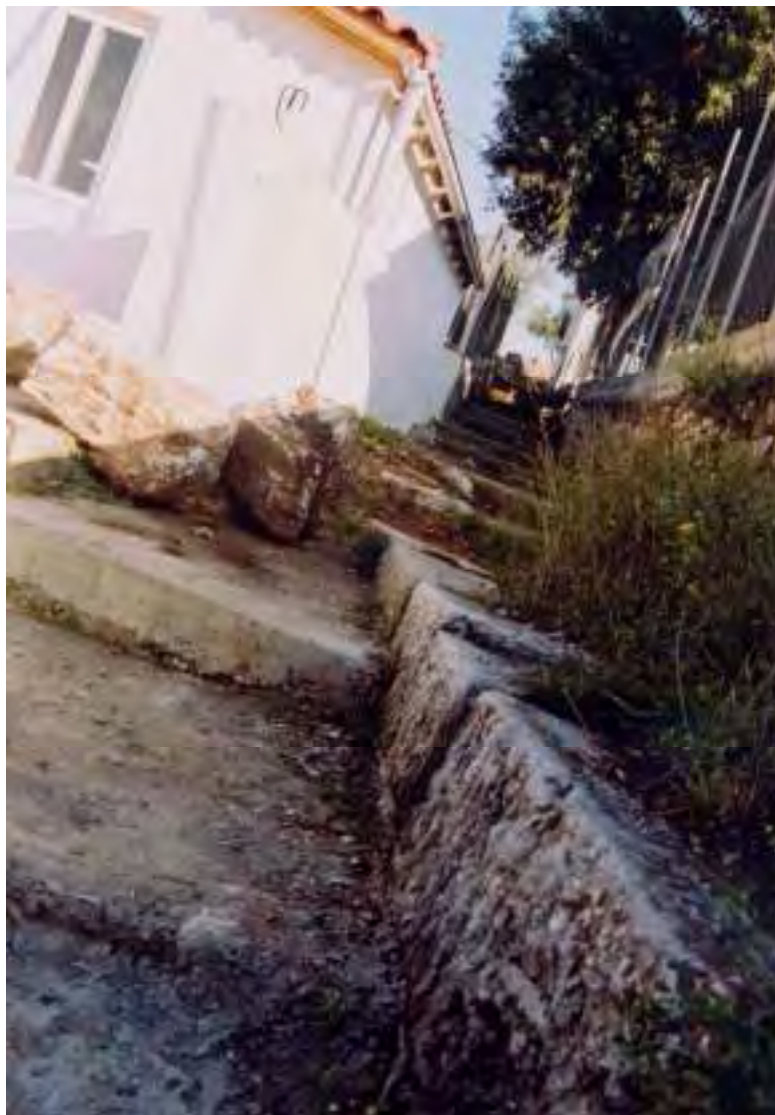
Εικ. 479/258. Οικισμός Κάτω Τριπόταμα Τριποτάμων Καλαβρύτων, θέση Σχολικό Συγκρότημα. Τμήμα της δυτικής πλευράς του τείχους σε σύγχρονο μονοπάτι, στα Δ του Σχολικού Συγκροτήματος
