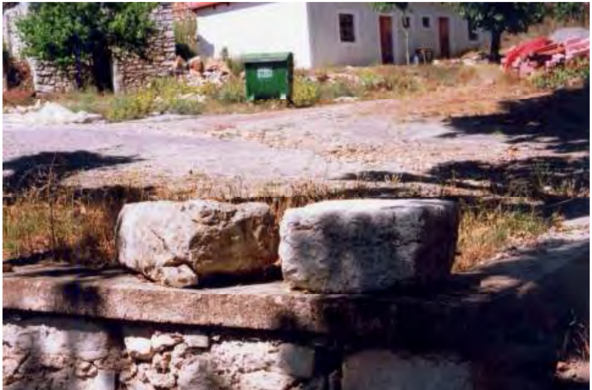
Εικ. 546/303. Πάος (παλ. τοπων. Σκούπι) Καλαβρύτων, θέση Χάνι του Καλαθά. Αρχιτεκτονικά μέλη στον αύλειο χώρο της οικίας Γ. Νικολακόπουλου
