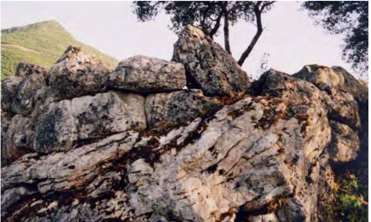
Εικ. 513/282. Αμυγδαλέα (παλ. τοπων. Μαμαλούκα) Καλαβρύτων, θέση Βορός. Μερική άποψη της βόρειας πλευράς του οχυρού, θεμελιωμένης στο φυσικό βράχο, από ΒΑ
