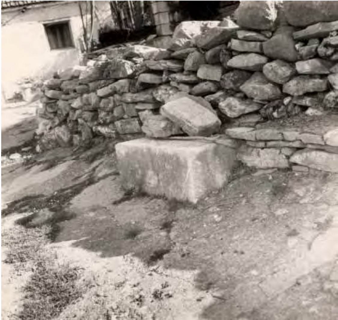
Εικ. 393/245. Οικισμός Κάτω Τριπόταμα Τριποτάμων Καλαβρύτων, θέση Βασιλική. Κυβόλιθοι και οικοδομικό υλικό στον άγλειο χώρο της οικίας Ι. Νικολακόπουλου
