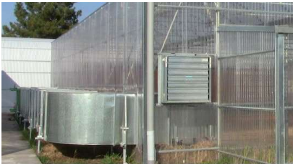
Εικόνα 24. Αεραγωγός Απορρόφησης των Υδρατμών, ορθογώνιας διατομής
