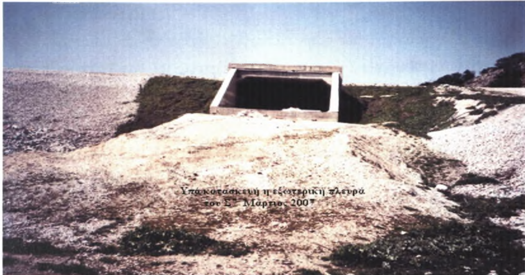
Φωτογραφία 12. Συλλεκτήρας Σ7 εξωτερική πλευρά.
