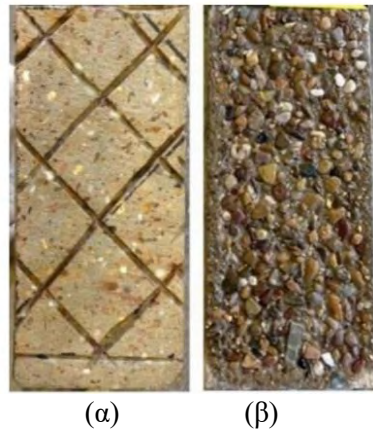
Σχήμα 6.5 Τρόποι προετοιμασίας της επιφάνειας σκυροδέματος: (α) ήπια εκτράχυνση και δημιουργία πλέγματος αυλακώσεων, και (β) αμμοβολή. (Raouf, 2017)
