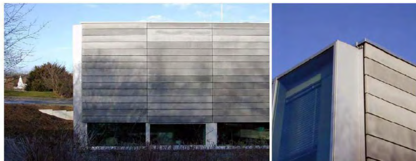
Σχήμα 3.2 Εφαρμογή στοιχείων κάλυψης από IAM στο κτίριο επέκτασης του Πολυτεχνείου του Aachen [RWTH Aachen University]. (Μπουρνάς, 2008)
