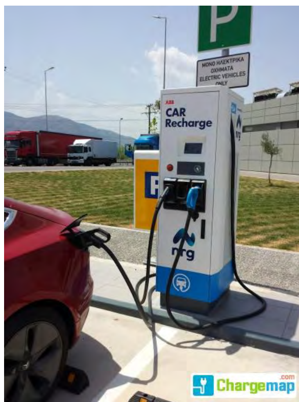
Εικόνα 28. Ταχυφορτιστής Terra 54 High Voltage της ABB στο ΣΕΑ Αταλάντης
