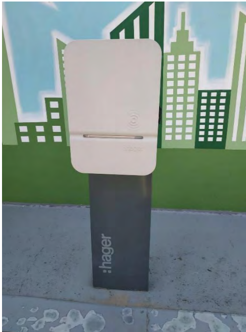
Εικόνα 26. Σταθμός φόρτισης στις Hager στο κατάστημα GERO
