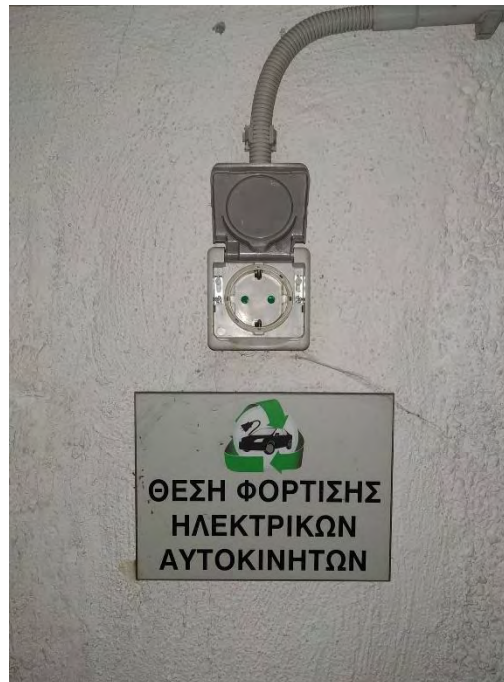
Εικόνα 23. Πρίζα φόρτισης ηλεκτρικού οχήματος στο parking «Πλατεία» (αργή φόρτιση)
