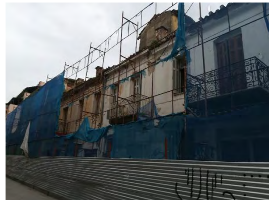
Εικόνα 17: Εγκαταλελειμμένο κτίσμα πλησίον της Αγοράς
