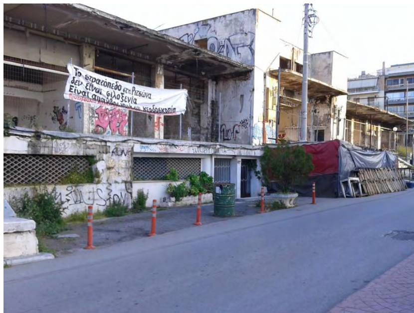
Εικόνα 16: Η σημερινή κατάσταση του κτίσματος της Β' φάσης κατασκευής, του Σόλωνα Κυδωνιάτη, στην οδό Νεοφύτου
