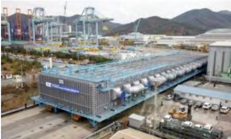
Εικόνα 8. Ο μεγαλύτερος εξατμιστήρας που χρησιμοποιείται για την μέθοδο της πολυβάθμιας εκτόνωσης, ένας από τους οχτώ που χρησιμοποιούνται στο εργοστάσιο αφαλάτωσης Ras Al Khair ( www.waterworld.com , 21/10/2013)
