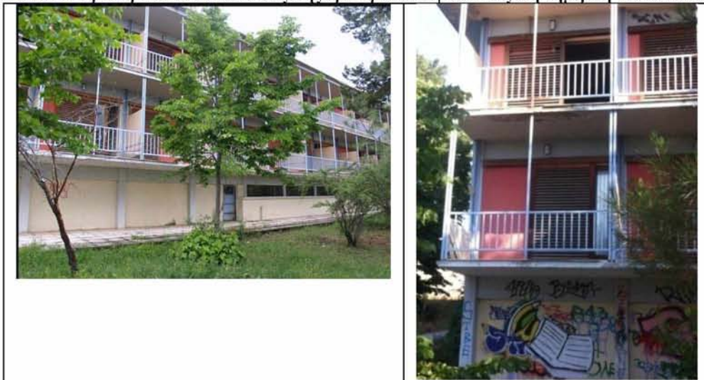
Εικόνα 37: Αριστερά είναι το Ξενία Κοζάνης πριν εγκαταλειφτεί &amp; δεξιά η σημερινή του κατάσταση
