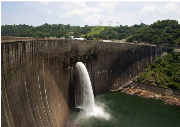
Εικόνα 3.3 Διάβρωση φράγματος Kariba [6]
