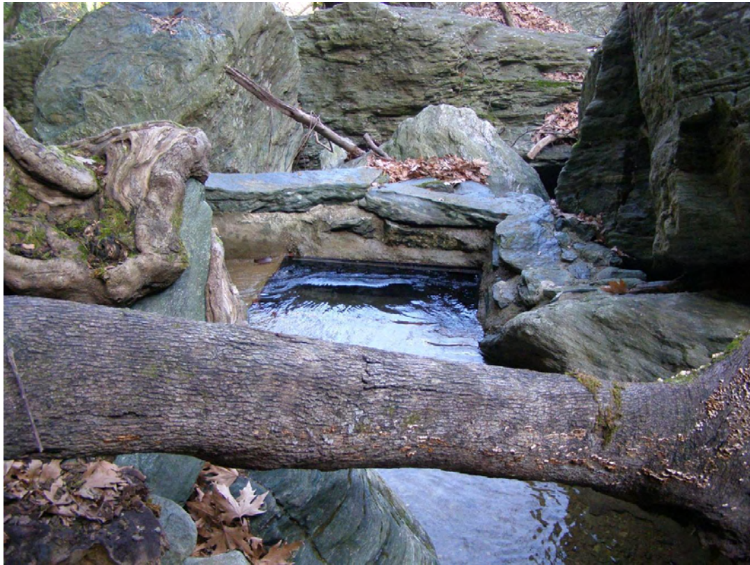
Εικόνα 7.3 Εισροή νερού σε αγωγό προσαγωγής που οδηγεί στη δεξαμενή φόρτισης
