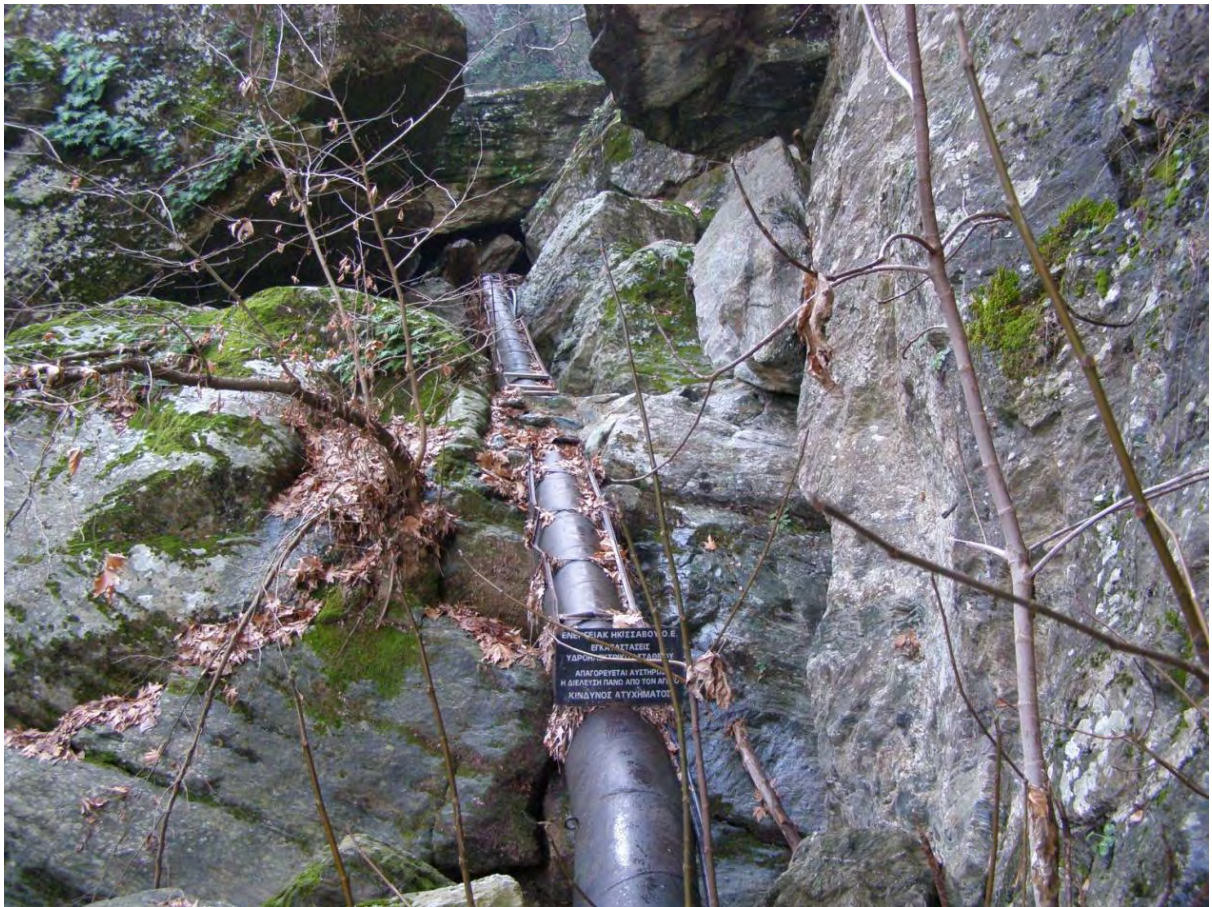
Εικόνα 7.4 Αγωγός πτώσης που κατευθύνει το νερό στον υδροστρόβιλο
