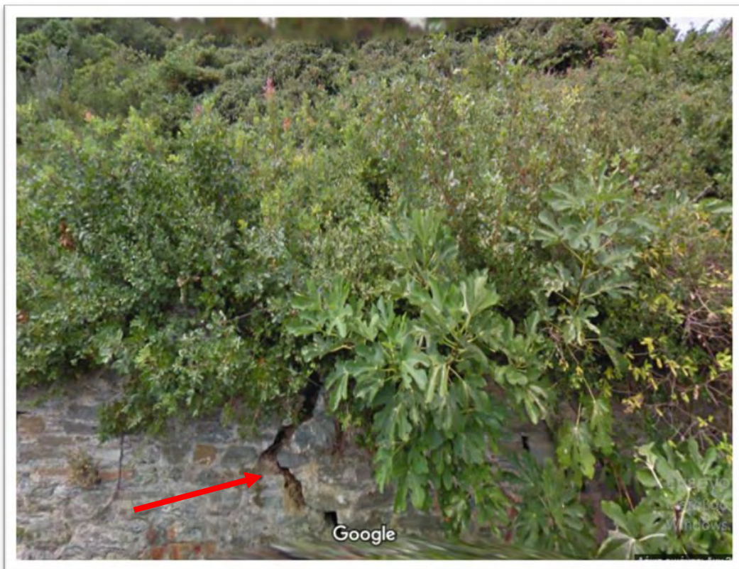
Εικόνα 4-5: Αστοχία τοίχου αντιστήριξης, [21].
