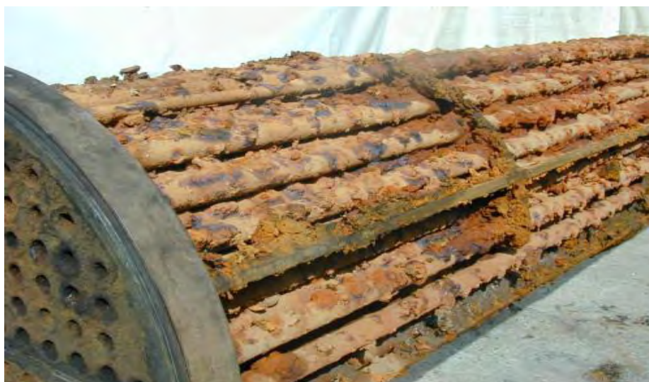
Εικόνα 5-6: Διάβρωση εναλλάκτη θερμότητας στο διυλιστήριο [36].
