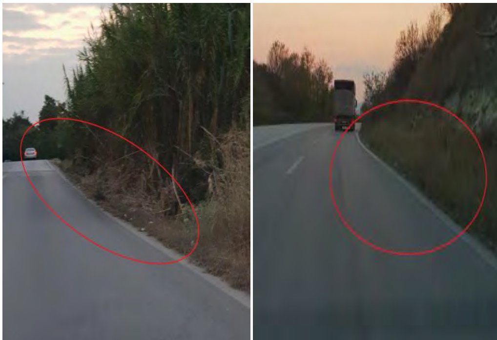
Έρεισμα με βλάστηση σε κακή κατάσταση , μη ύπαρξη ΛΕΑ
