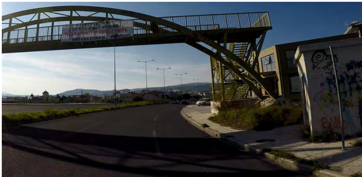
Εικόνα 3.1-48: Κτήριο και βάθρο πεζογέφυρας χωρίς στηθαίο ασφαλείας στη χιλιομετρική θέση 6+048 στο ρεύμα προς Λαρίσης.
