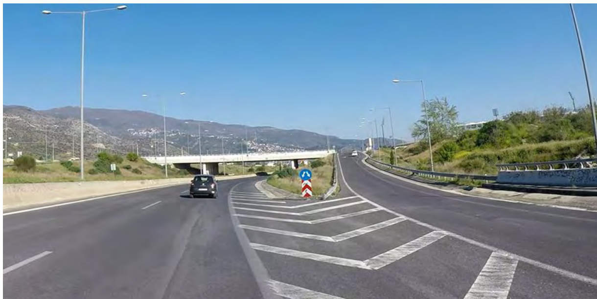
Εικόνα 3.1-60: Ελλειψή προστασία στη διαχωριστική νησίδα ανισόπεδου κόμβου στη χιλιομετρική θέση 2+912 στο ρεύμα προς Γορίτσα.
