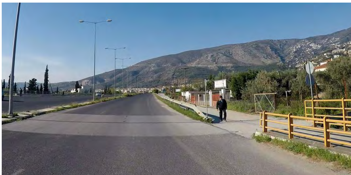
Εικόνα 3.1-20: Σύνδεση παράπλευρης οδού χωρίς τις απαραίτητες προδιαγραφές στη χιλιομετρική θέση 7+736.
