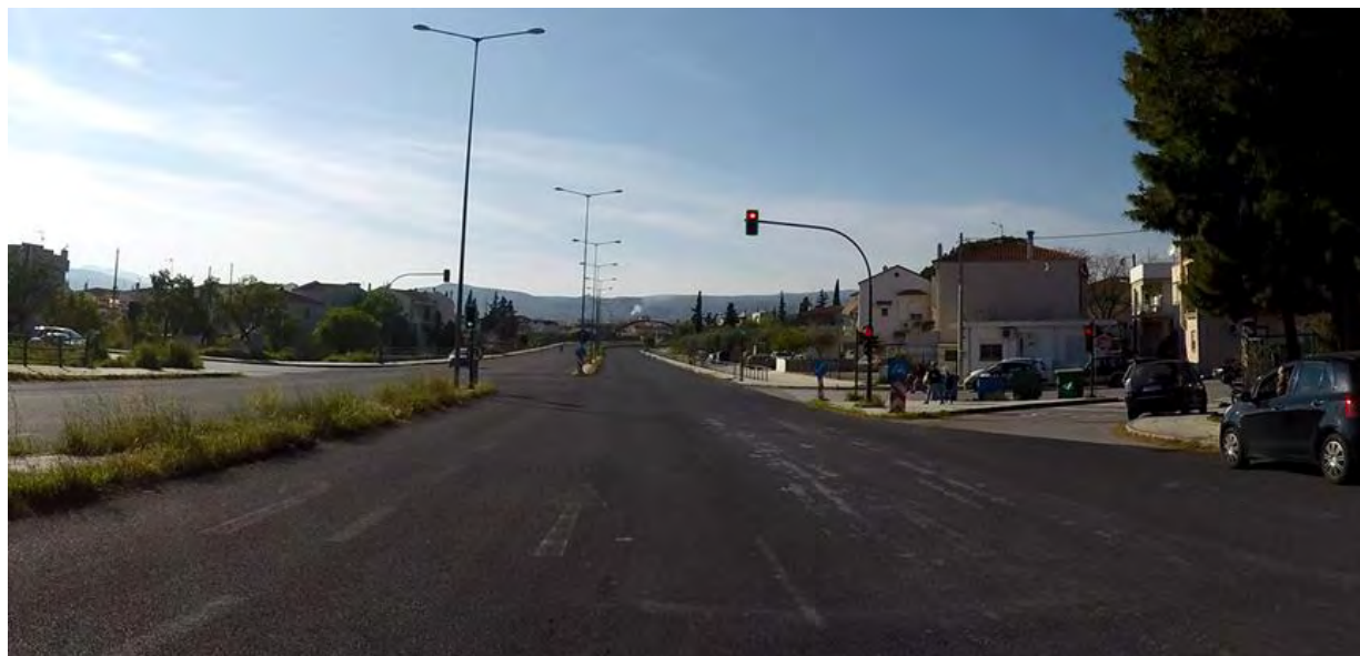
Εικόνα 3.1-17: Φθορές στην άσφαλτο του οδοστρώματος στη χιλιομετρική θέση 6+286 στο ρεύμα προς Λαρίσης.
