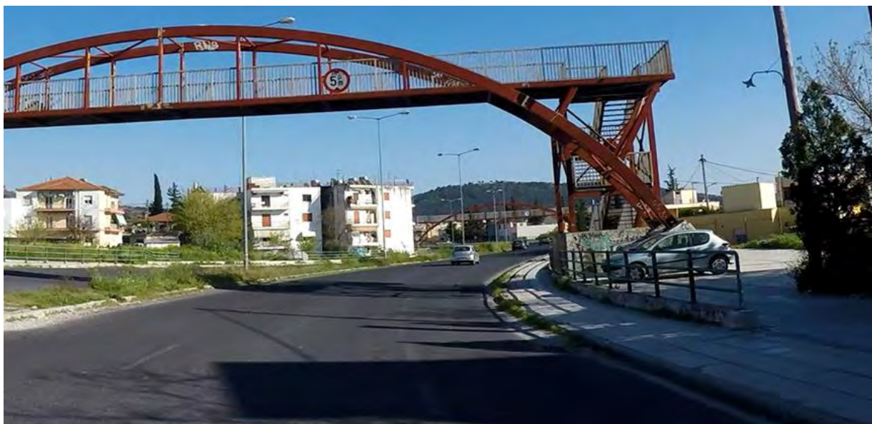
Εικόνα 3.1-45: Βάθρο πεζογέφυρας με κγκλίδωμα χωρίς στηθαίο ασφαλείας στη χιλιομετρική θέση 6+492 στο ρεύμα προς Γορίτσα.
