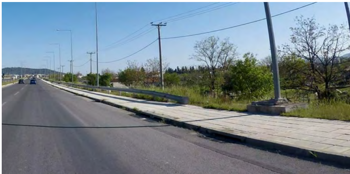
Εικόνα 3.1-42: Στύλος οδοφωτισμού χωρίς στηθαίο ασφαλείας στη χιλιομετρική θέση 5+030 στο ρεύμα προς Γορίτσα.
