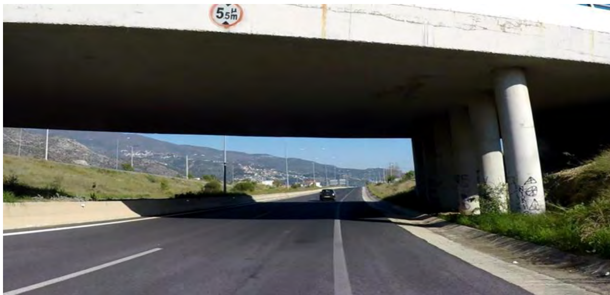
Εικόνα 3.1-40: Βάθρα γέφυρας πίσω από τριγωνική τάφρο χωρίς στηθαία ασφαλείας στη χιλιομετρική θέση 3+075 στο ρεύμα προς Γορίτσα.
