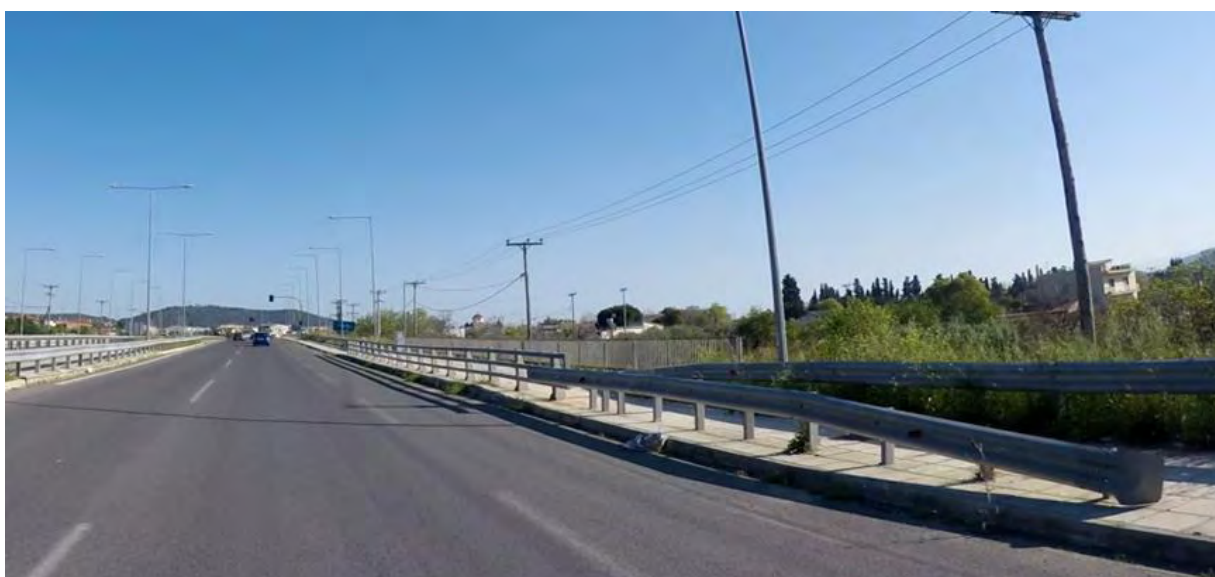
Εικόνα 3.1-59: Προβληματική τοποθέτηση στηθαίου ασφαλείας και απόληξης.
