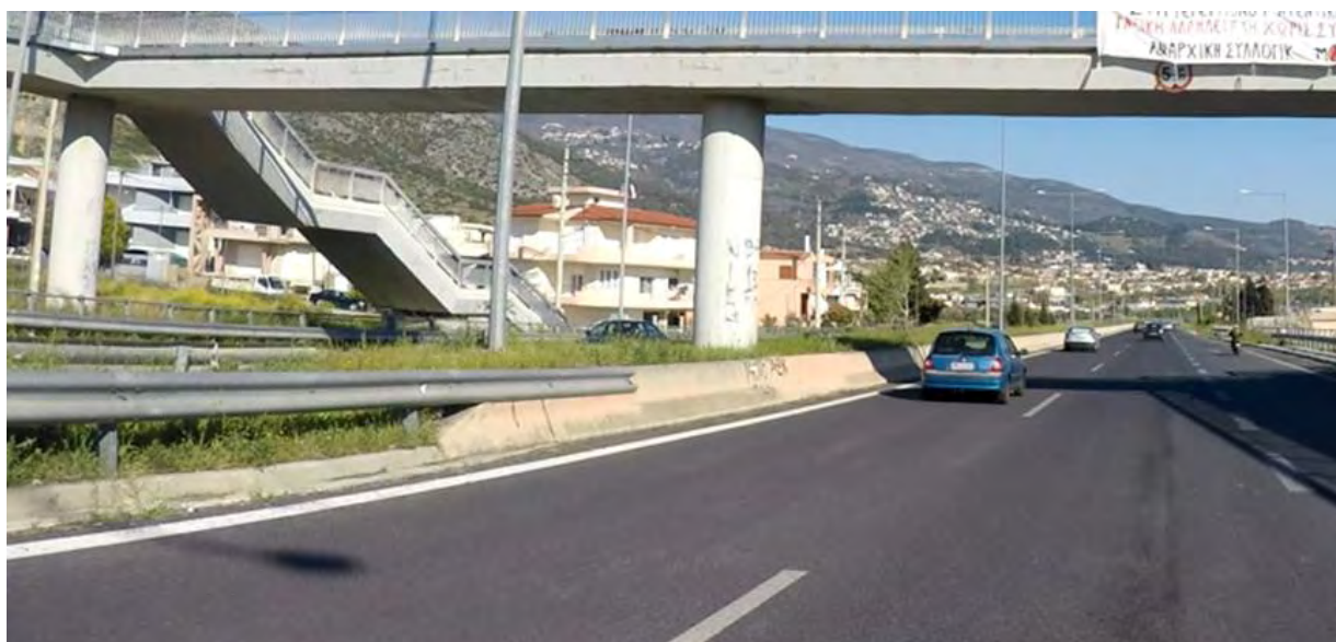
Εικόνα 3.1-41: Συναρμογή μεταλλικού στηθαίου με σκυροδέματος χωρίς ειδικό τεμάχιο προσαρμογής στη χιλιομετρική θέση 4+300 στο ρεύμα προς Γορίτσα.
