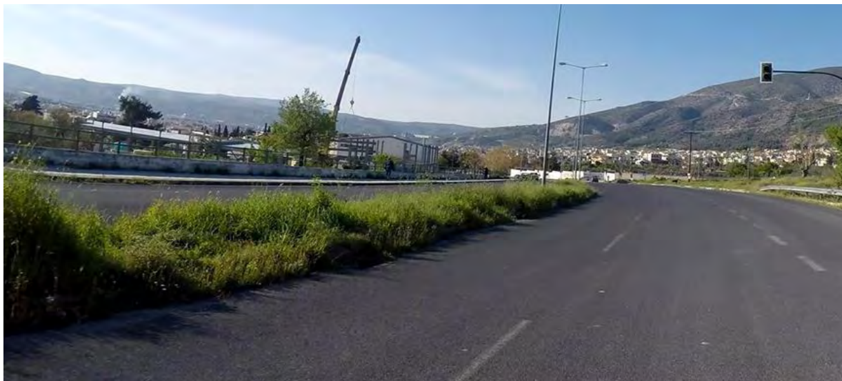
Εικόνα 3.1-30: Μείωση ορατότητας λόγω φυτοκάλυψης της οδού η οποία εισέρχεται και στο οδόστρωμα στη χιλιομετρική θέση 7+400 στο τμήμα προς Λαρίση.
