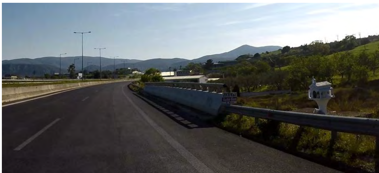
Εικόνα 3.1-63: Μη κατάλληλη προσαρμογή μεταλλικού στηθαίου με σκυροδέματος.
