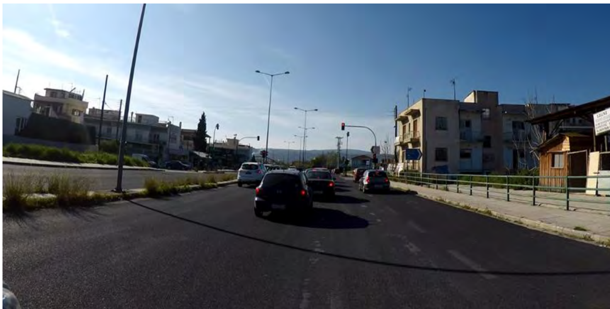
Εικόνα 3.1-16: Φθορές στην άσφαλτο του οδοστρώματος στη χιλιομετρική θέση 6+960 στο ρεύμα προς Λαρίσης.
