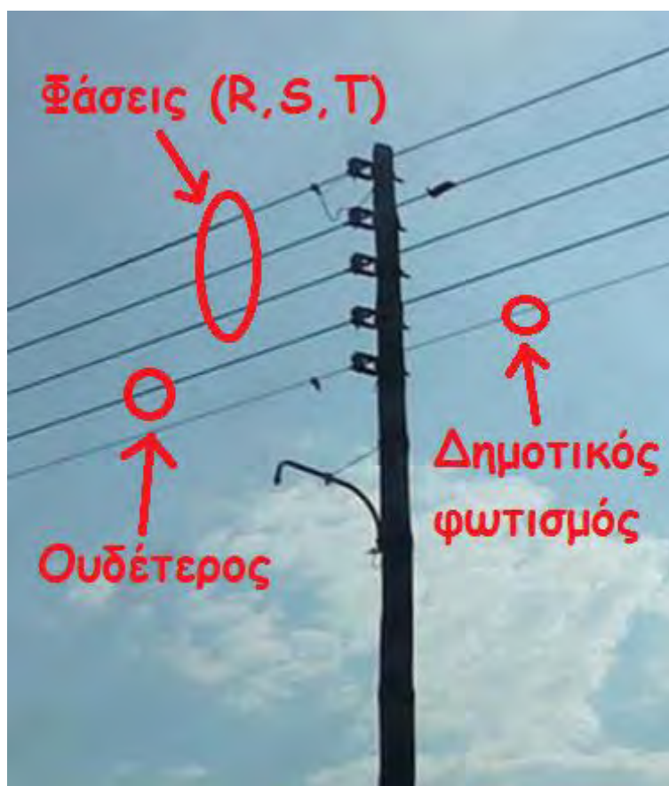
Εικόνα 2.7: Ξύλινος στύλος χαμηλής τάσης
