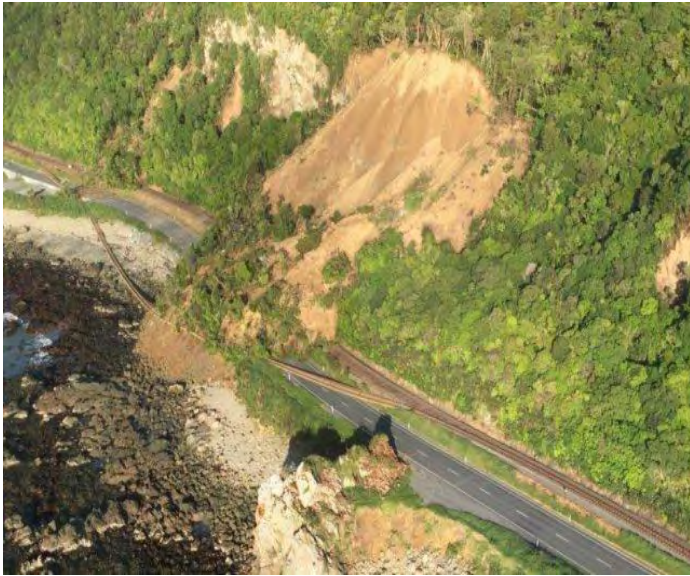
Σχήμα 3.27: Κατολίσηση πρανούς και καταστροφή της σιδηροδρομικής γραμμής της Νέας Ζηλανδίας .
