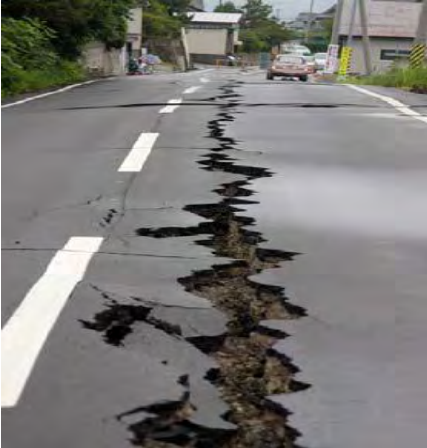
Σχήμα 3.17: Αστοχία οδοστρώματος κατά την διάρκεια του σεισμού της Nigata–Chuetsu (Ιαπωνία, 2004).
