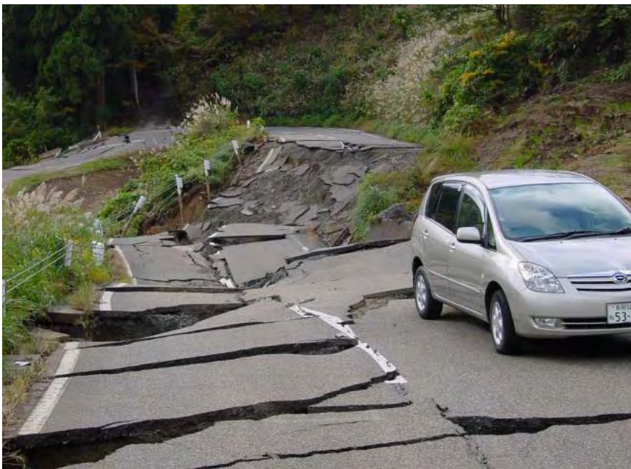
Σχήμα 3.16: Καταστροφή οδοστρώματος κατά τον σεισμό Nigata- Ken Chuetsu (Ιαπωνία).
