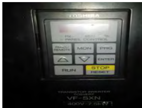
Εικόνα 3.13- Πίνακας Ελέγχου για τη ρύθμιση της ταχύτητας στην Αεροσήραγγα
