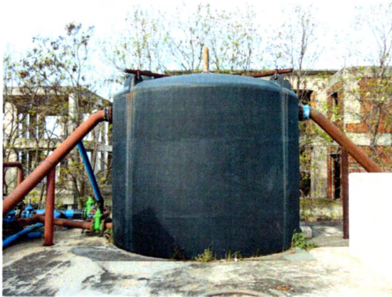
Σχήμα 4.2 Δεξαμενή προσωρινής αποθήκευσης του νερού γεώτρησης
