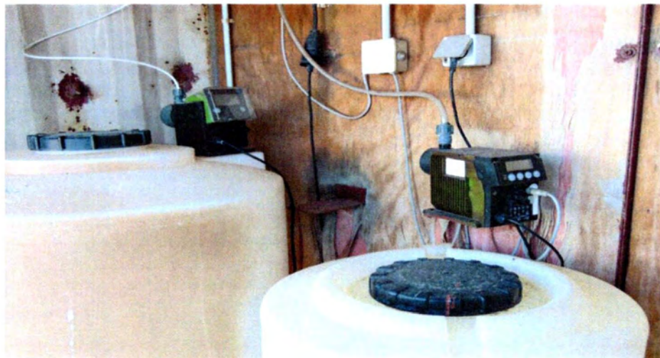
Σχήμα 4.15 Χώρος αποθήκευσης χημικών.
