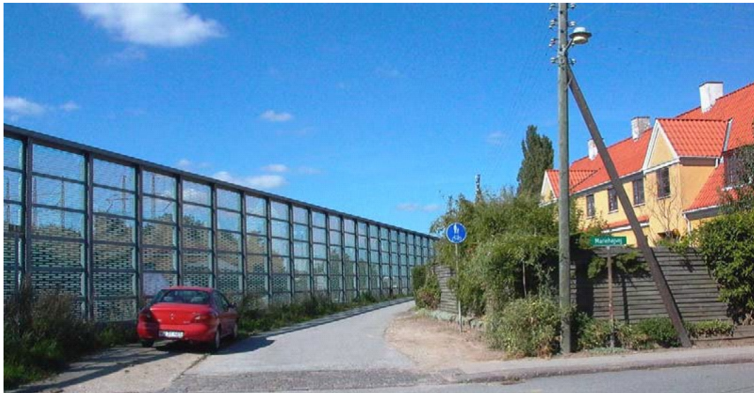
Σχήμα 3-4: Ψηλό διαφανές πέτασμα 5m στον M14 αυτοκινητόδρομο στην Κοπεγχάγη, Δανία Πηγή: Danish Road Institute Report 174,2009
