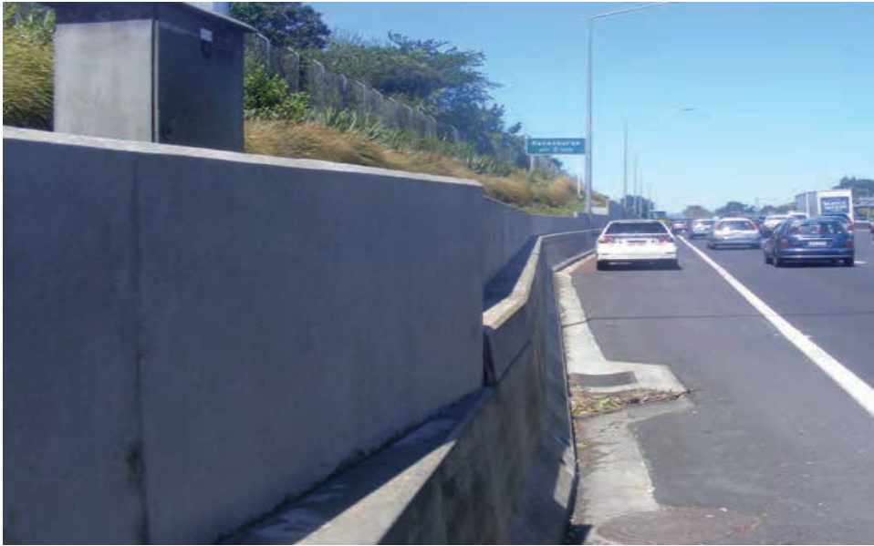
Σχήμα 4-8: Ύστερη απεικόνιση. Ο κίνδυνος μετριάστηκε με την προσθήκη μεταβατικών μπλοκ στην κορυφή των στηθαίων ασφαλείας από σκυρόδεμα. Πηγή: Noise Transport Agency, 2012.
