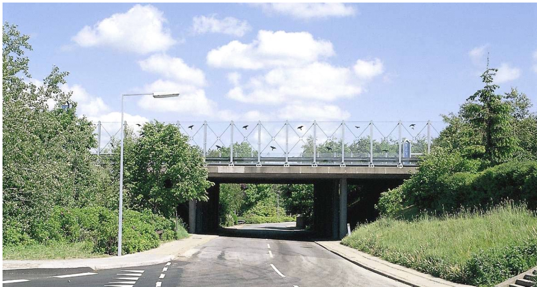
Σχήμα 3-5: Διαφανές αντιθορυβικό πέτασμα που βρίσκεται στη διασταύρωση του αυτοκινητόδρομου M70 με έναν τοπικό δρόμο, στο Alborg, Δανία Πηγή: Danish Road Institute Report 174,2009
