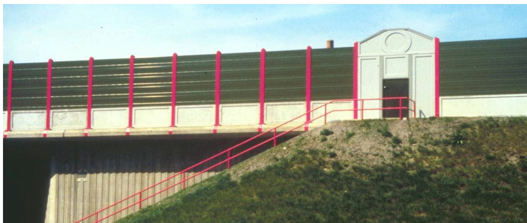
Σχήμα 3-14: Μεταλλικό αντιθορυβικό πέτασμα ύψους 3,5m., Γερμανία Πηγή: Danish Road Institute Report 174,2009
