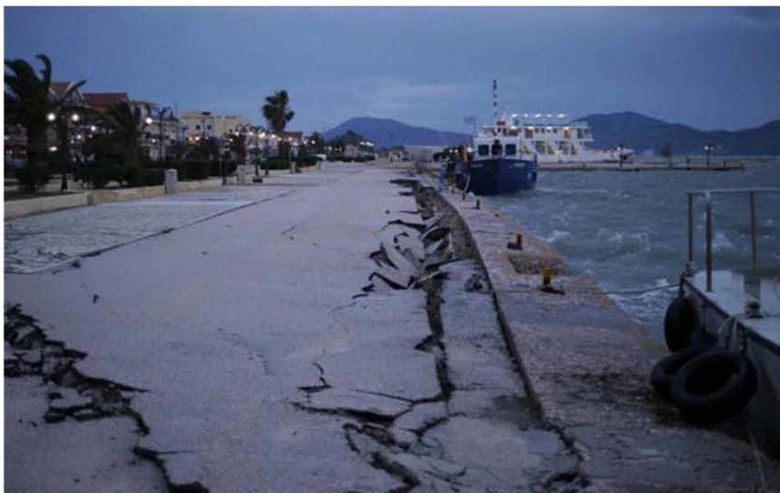
Εικόνα 4.8 - Ρήγμα στο λιμάνι του Ληξουρίου ( www.naftemporiki.gr )
