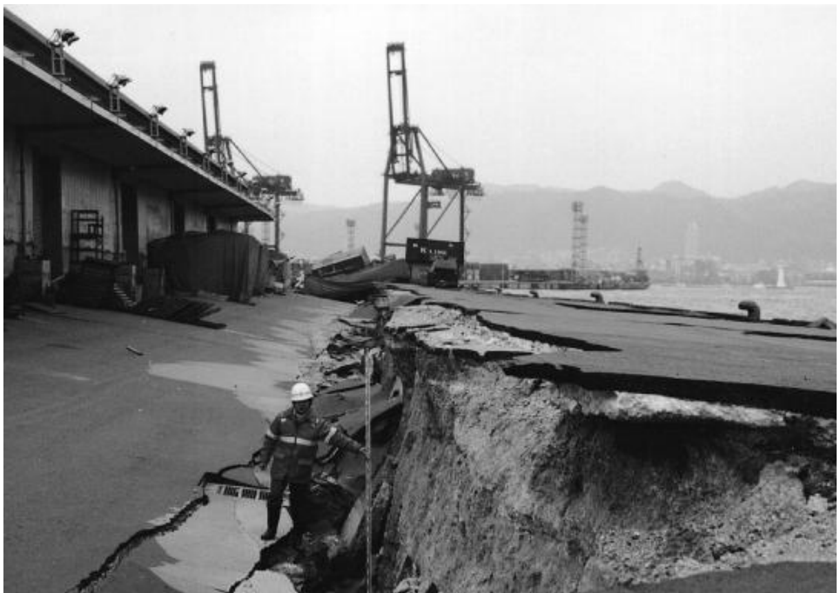
Σχήμα 1.3 Μέρη του λιμανιού του Κοβε αμέσως μετά τον σεισμό του 1995
