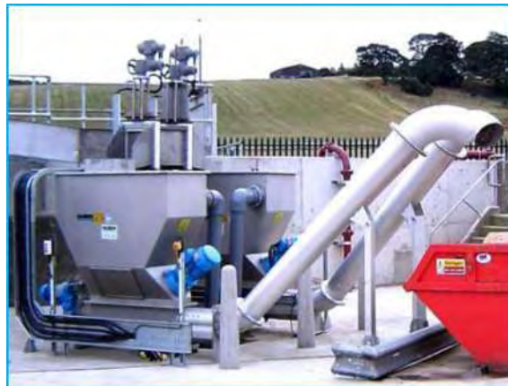
Εικόνα 5.3.2.2. Πρέσα και μηχανισμός απομάκρυνσης εσχαρισμάτων
