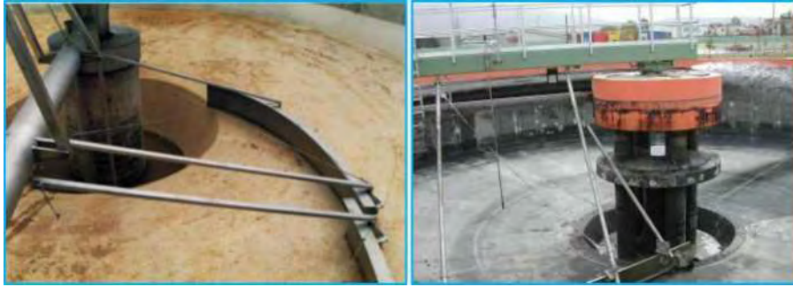
Εικόνα 5.3.4.2. Σαρωτής ιλύος και κώνος συγκέντρωσης ιλύος σε κυκλική δεξαμενή καθίζησης
