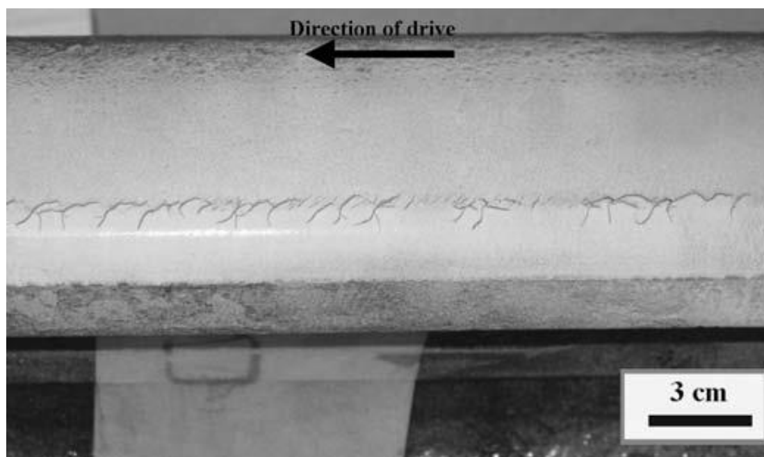
Εικόνα 1.3.1: Εκτεταμένο shelling στην επιφάνεια σιδηροτροχιάς [8]
