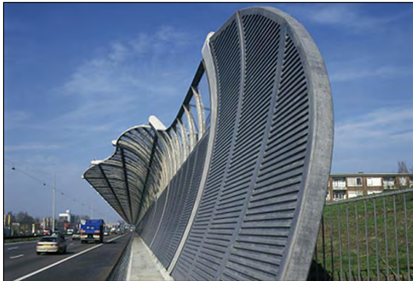
Εικόνα 23. Ηχοπέτασμα από σκυρόδεμα με πάνελ παραγωγής ενέργειας και ανοίγματα για οπτική επαφή στο Ντόρντρεχτ της Ολλανδίας
