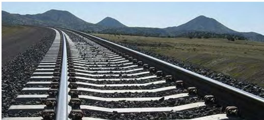
Εικόνα 1: Στρωτήρες Σιδηροτροχιάς από Μπετόν
