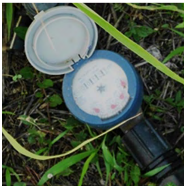
Εικόνα 5.16. Υδρόμετρο τοποθετημένο στον πειραματικό αγρό.
