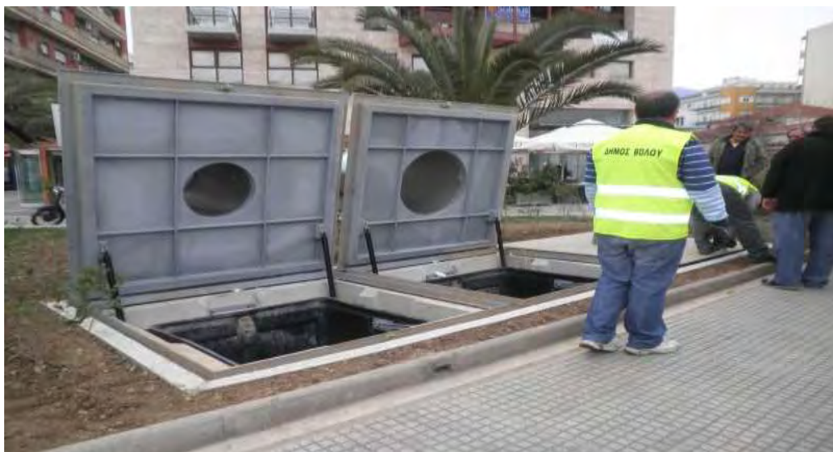
Εικόνα 53: Σημείο εγκατάστασης υπόγειων κάδων συλλογής απορριμμάτων, επί της οδού Αργοναυτών, στην είσοδο του λιμανιού
