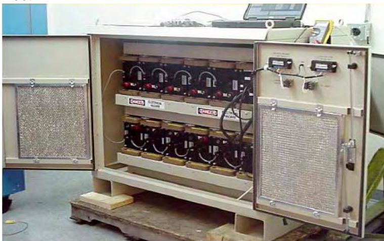
Εικόνα 3.2 Σύστημα ενεργειακής αποθήκευσης μπαταρίας ιόντος λιθίου των 100 kW
