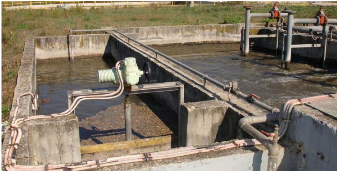
Σχήμα 4.4: Εξαμμωτής αεριζόμενου τύπου (δεξαμενή στα δεξιά) και λιποσυλλέκτης (δεξαμενή στα αριστερά)
