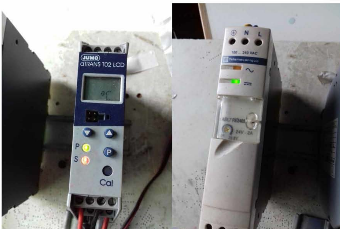
Σχήμα 4.14 Το transmitter jumo και το τροφοδοτικό της telemecanique
