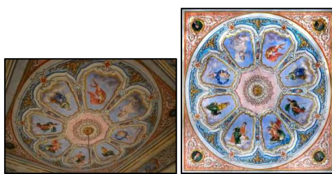
Εικόνες 280-281. Οροφογραφίες Αρχοντικού Κοή. Πηγή: Προσωπικό αρχείο, Προσωπικό αρχείο κ. Σ. Κοή.
