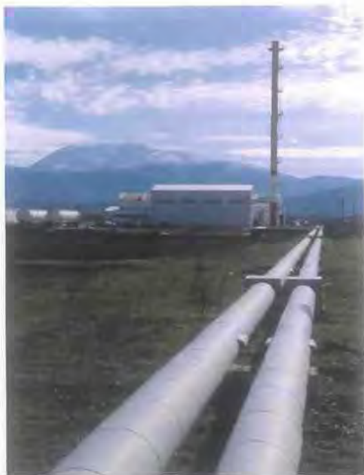
Εικόνα 37: Δίκτυο τηλεθέρμανσης στην Κοζάνη
