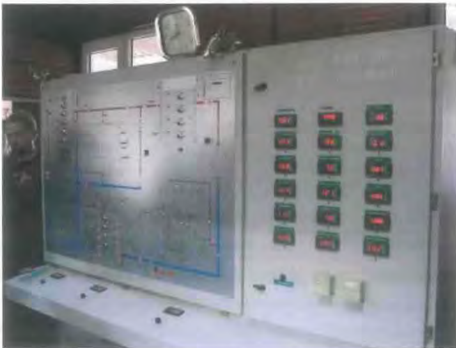
Εικόνα 67: Πίνακας ελέγχου με τα όργανα ρυθμίσεων και μετρήσεων
