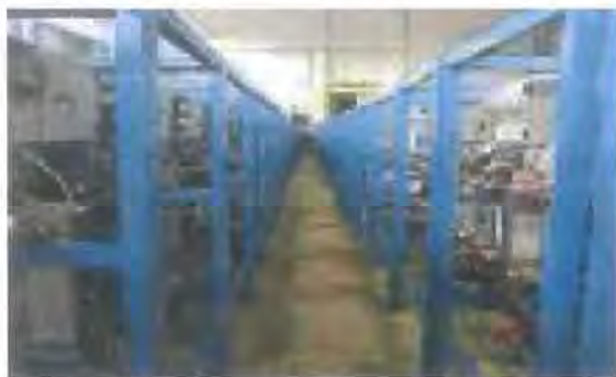
Εικόνα 35: Αντλιοστάσιο στην Μεγαλόπολη
