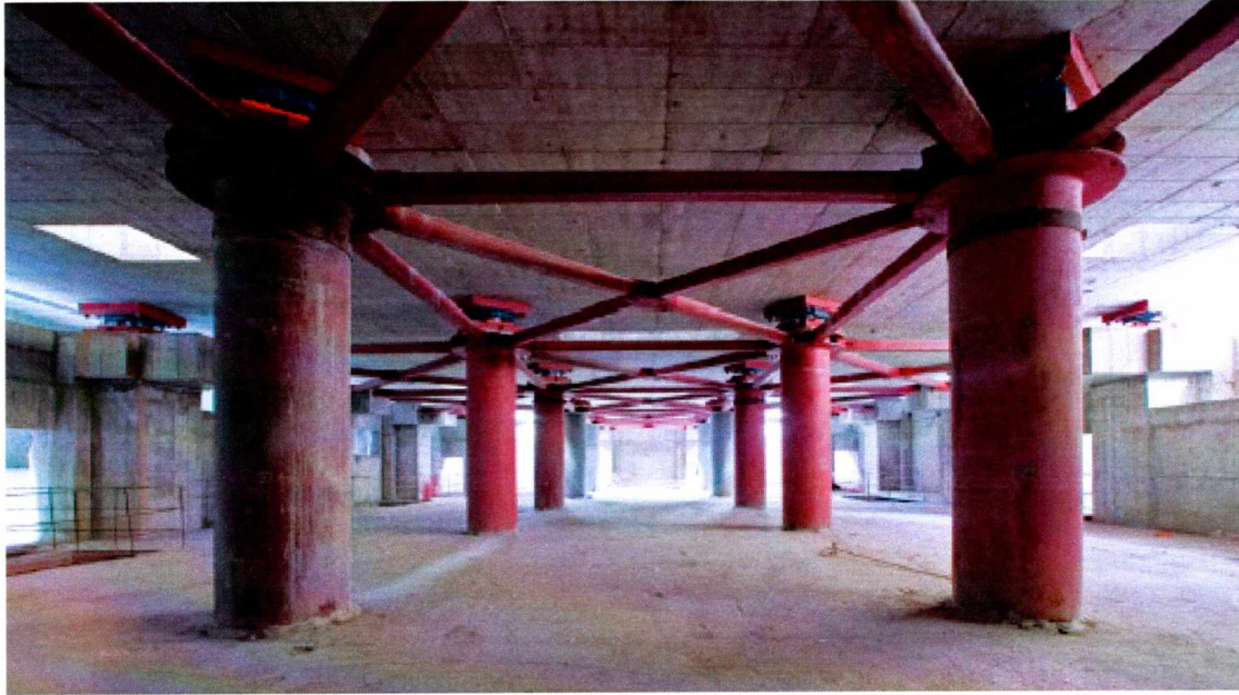
Εικόνα 2 Το μεταλλικό δικτύωμα που χρησιμοποιήθηκε κάτω από το επίπεδο της Σεισμικής Μόνωσης στην Ωνάσειο Στέγη Γραμμάτων και Τεχνών.
