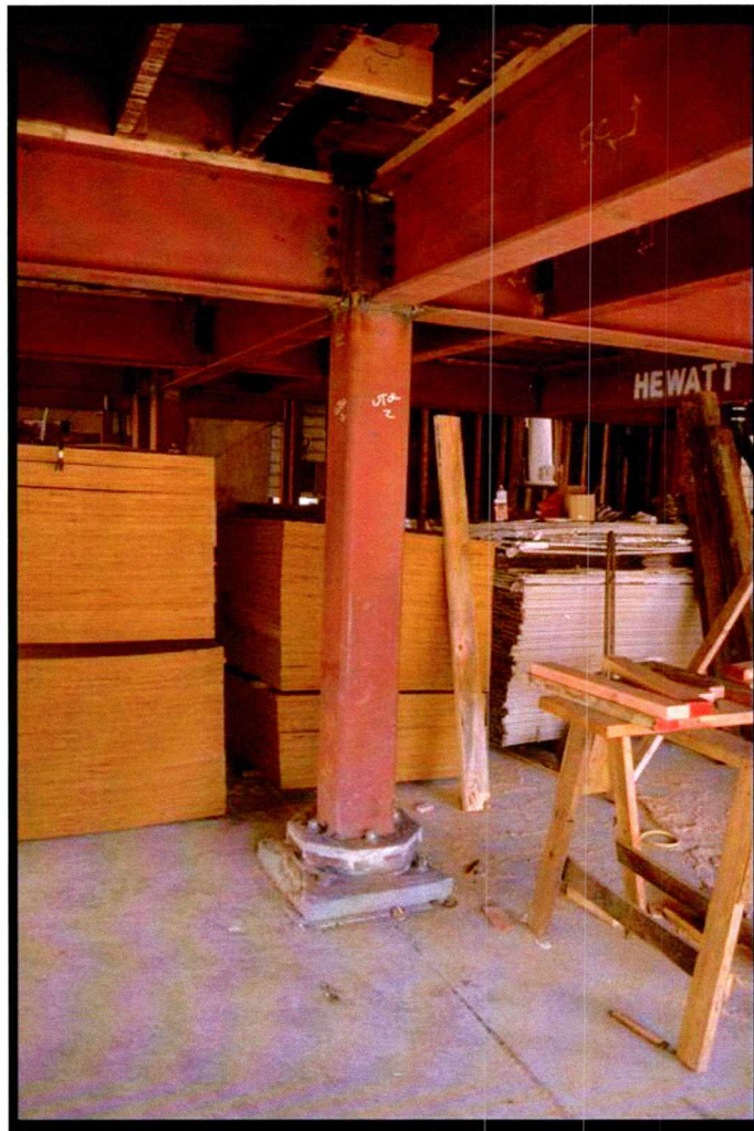
Φωτογραφία 1.2 Κτίριο Hawly Apartments - Μεταλλικό υποστόλωμα χωρίς διάφραγμα αμέσως επάνω από τα εφέδρανα.
