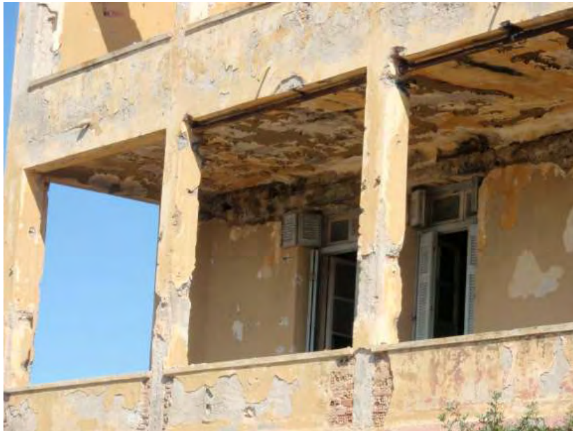
Εικόνα 69. Κοντινή λήψη στους εξώστες αεροθεραπείας. Τα ξύλινα παραθυρόφυλλα χωρίζονταν σε δύο άνισα μέρη, ώστε το άνοιγμα και το κλείσιμο τους να ρυθμίζει την εισερχόμενη ακτινοβολία. Τα μικρά παραθυρόφυλλα και τζάμια μπορούσαν να μείνουν ανοιχτά στη διάρκεια της νύχτας, ώστε να εισέρχεται καθαρός αέρας για τους νοσηλευόμενους φυματικούς και την ίδια στιγμή να περιορίζεται η ροή των ρευμάτων κρύου αέρα.
