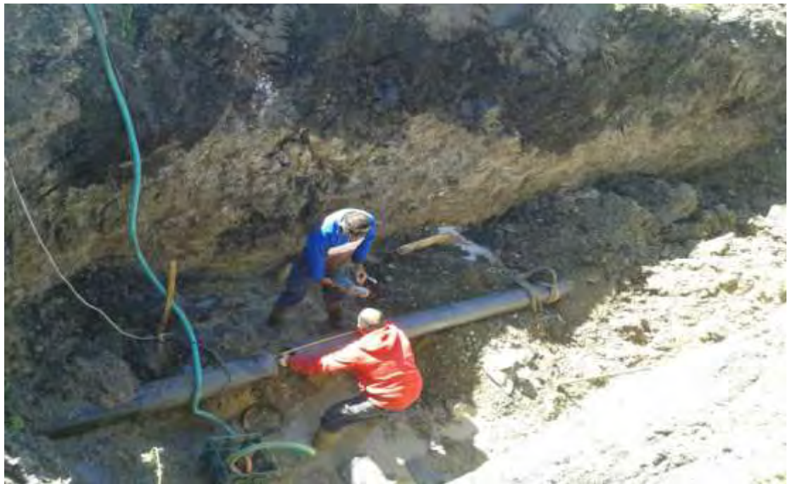
Εικόνα 5.32 βλάβη 6η διάρρηξη αγωγού στη ζώνη Σ3
