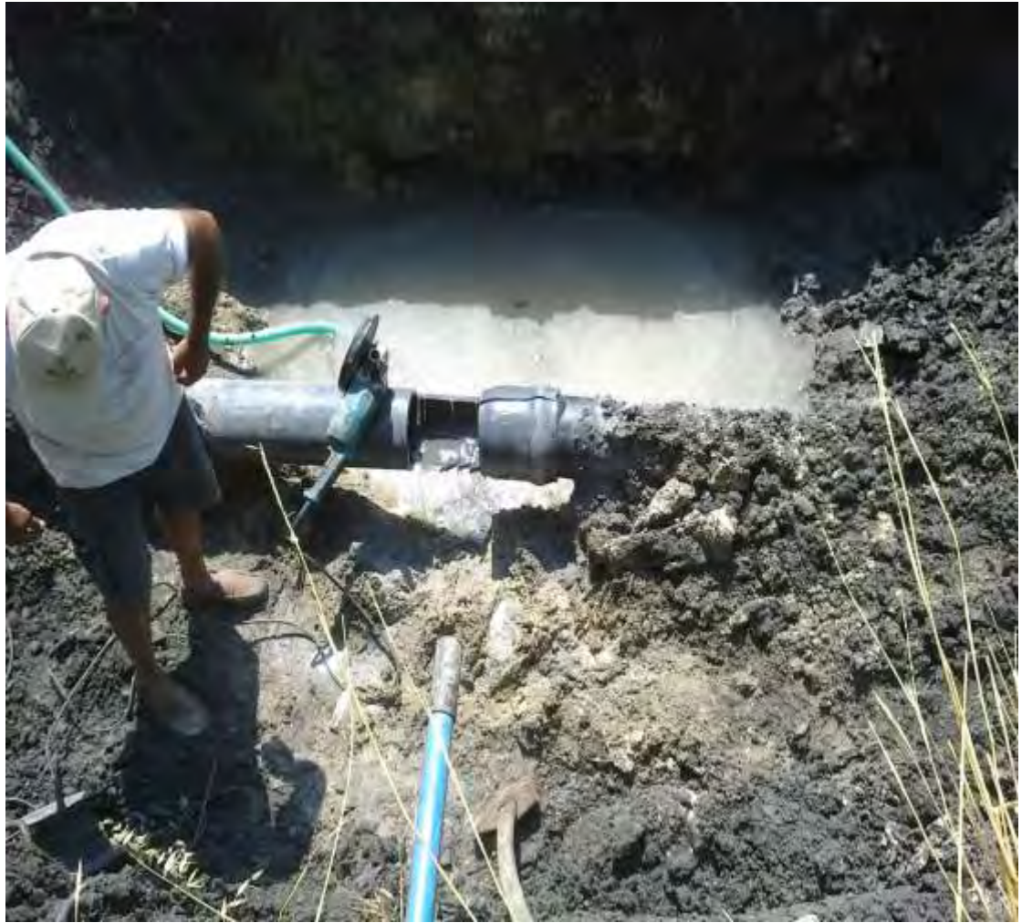
Εικόνα 5.12 βλαβη 12η διαρρηξη αγωγου στη ζώνη Σ3
