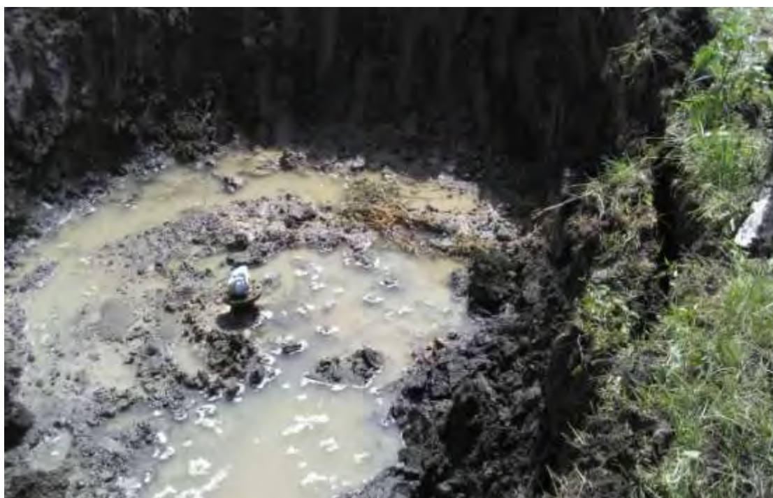
Εικόνα 5.37 βλάβη 11η διάρρηξη αγωγού στη ζώνη Σ4
