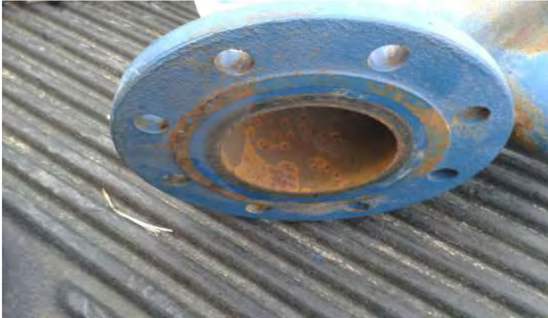
Εικόνα 5.18 βλαβή 6η διαβρωση ελαστικού δακτυλίου στη ζώνη Σ2
