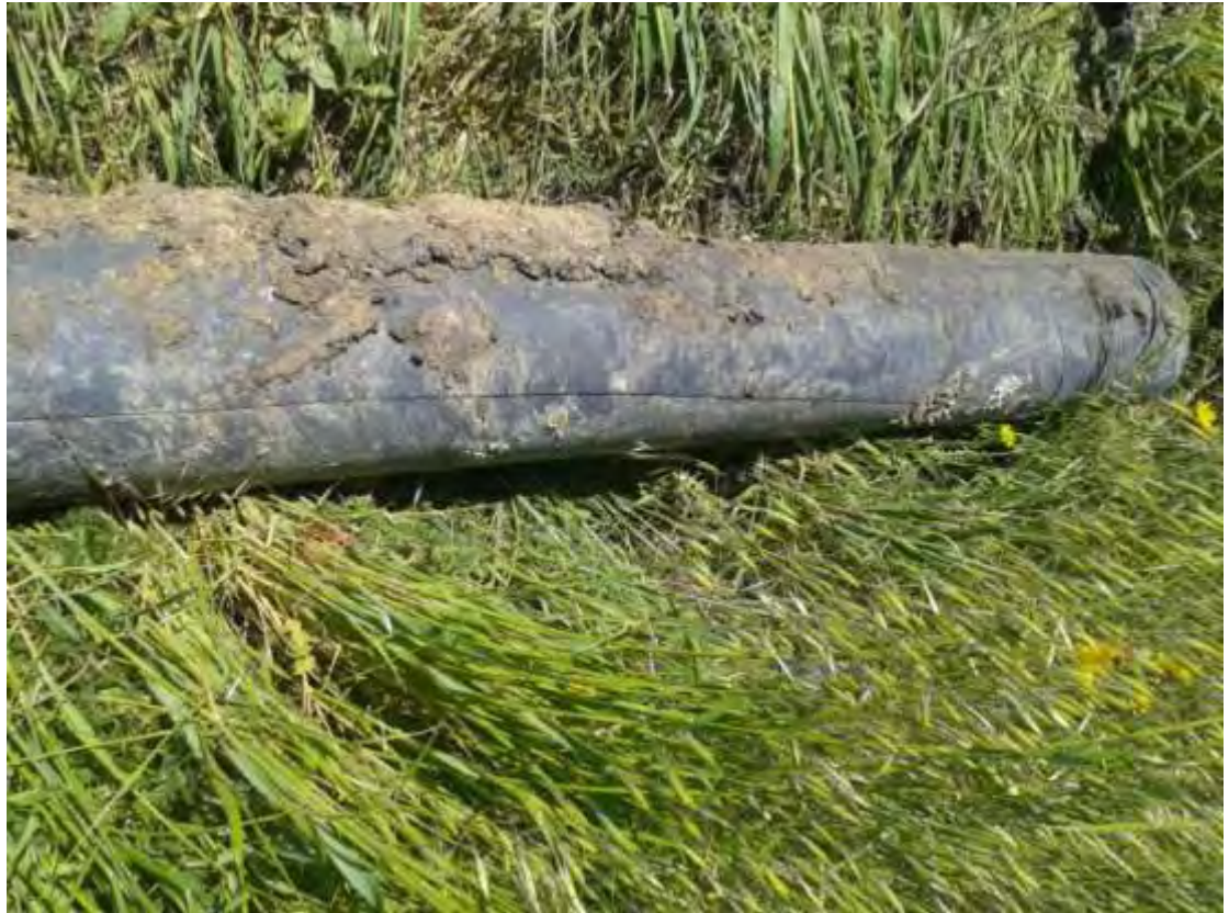
Εικόνα 5.31 βλάβη 5η διάρρηξη αγωγού στη ζώνη Σ3
