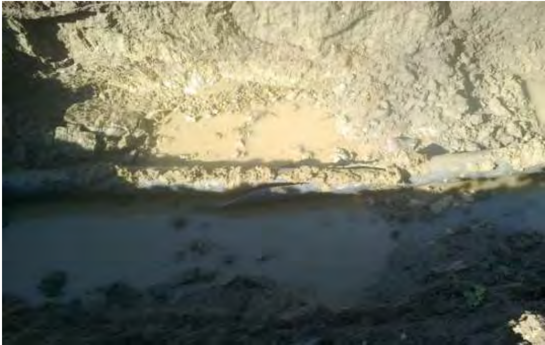
Εικόνα 5.11 βλαβη 11η διαρρηξη αγωγου στη ζώνη Σ3
