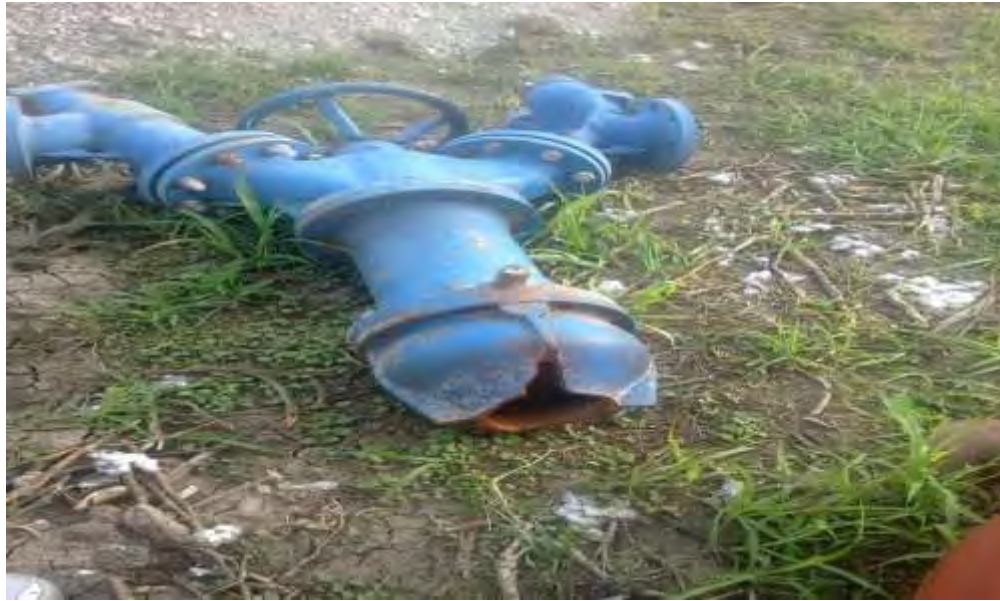
Εικόνα 5.2 βλάβη 2 η σπάσιμο υδροληψείας στη ζώνη Σ2
