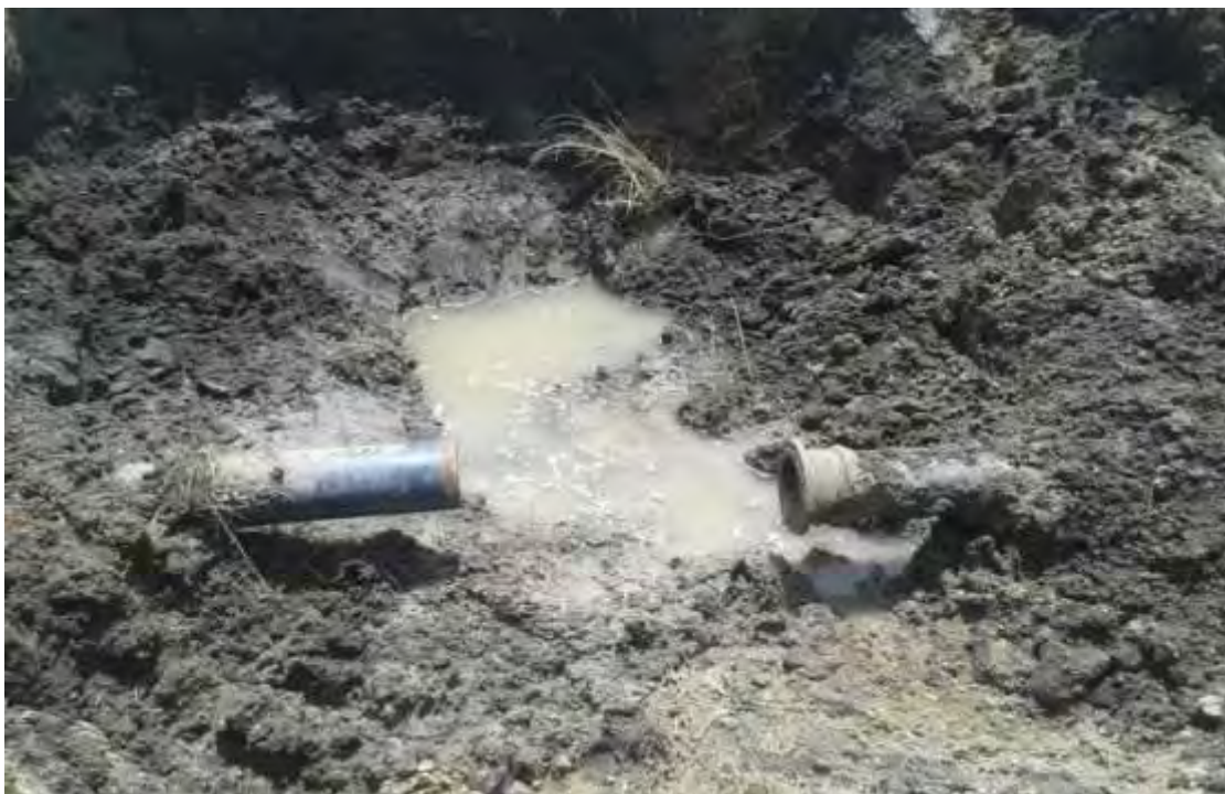
Εικόνα 5.10 βλαβη 10η διαρρηξη αγωγου στη ζώνη Σ3
