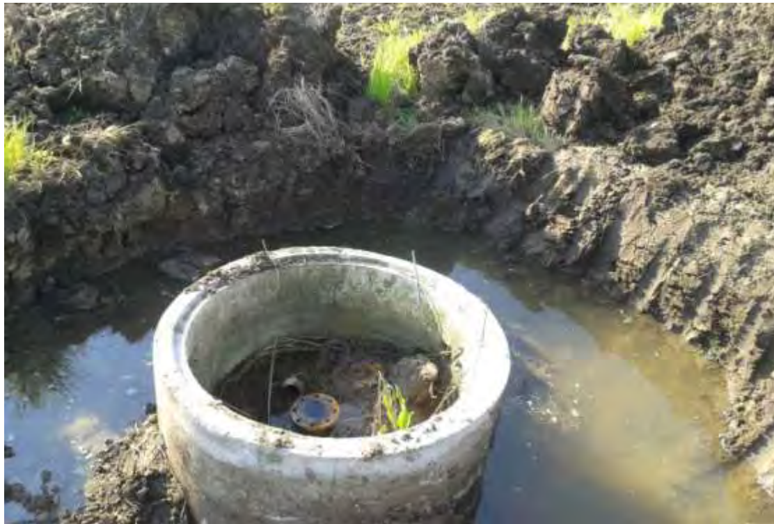
Εικόνα 5.14 βλαβη 2η διαρρηξη αγωγού στη ζώνη Σ4
