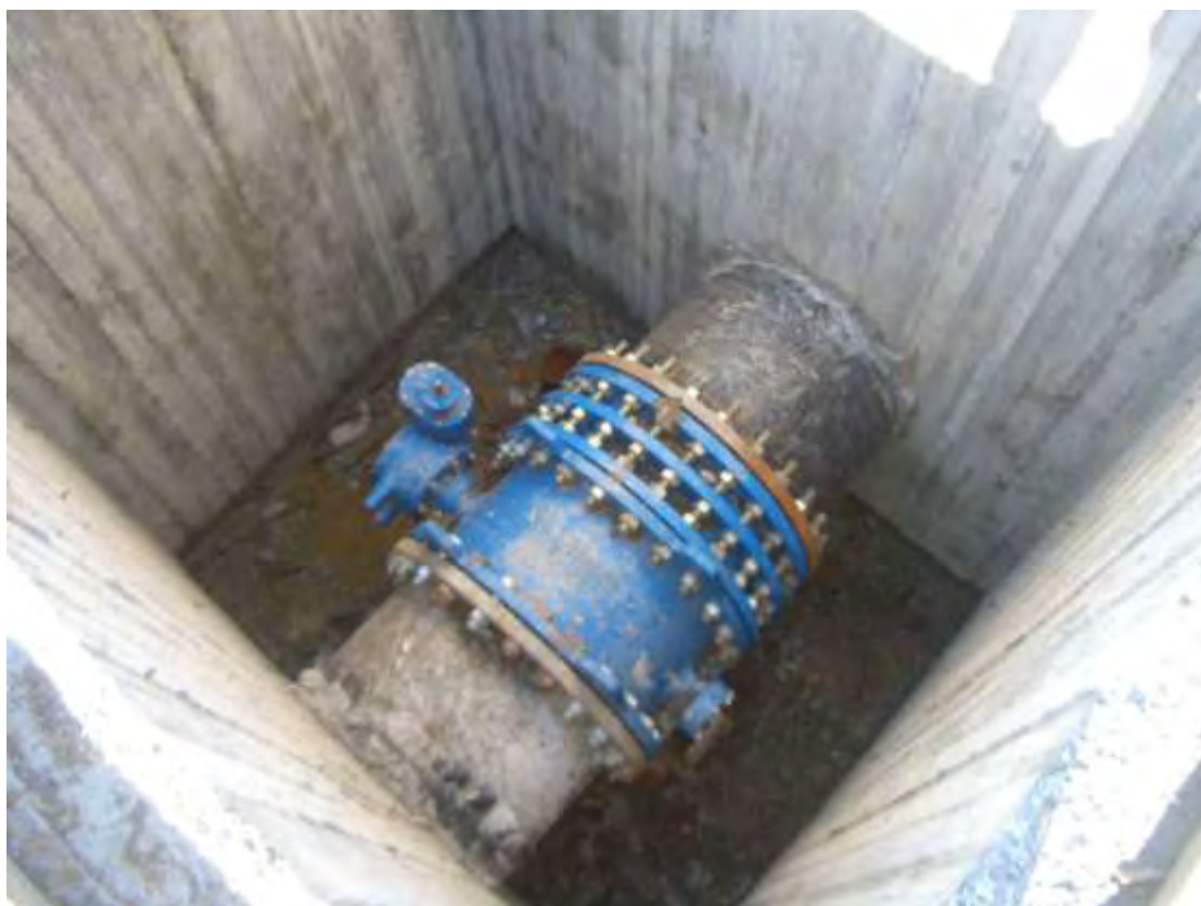
Εικόνα 4.2: Φρεάτιο κλειστού αγωγού Σ2
