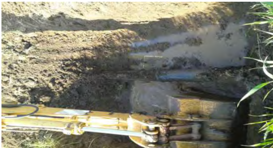
Εικόνα 5.15 βλαβη 3η διαρρηξη αγωγού στη ζώνη Σ4
