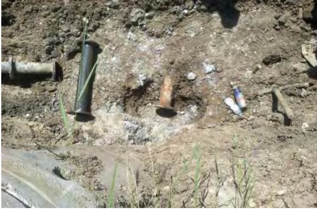
Εικόνα 5.6 βλαβη 6η σπασσιμο υδροληψειας στη ζώνη Σ2
