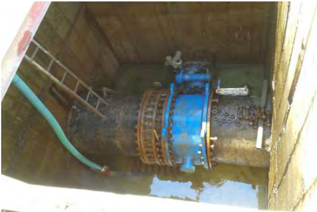
Εικόνα 5.23 βλαβη 11η φθορά ελαστικού παρεμβύσματος στον φ1600 αγωγό στη ζώνη Σ3
