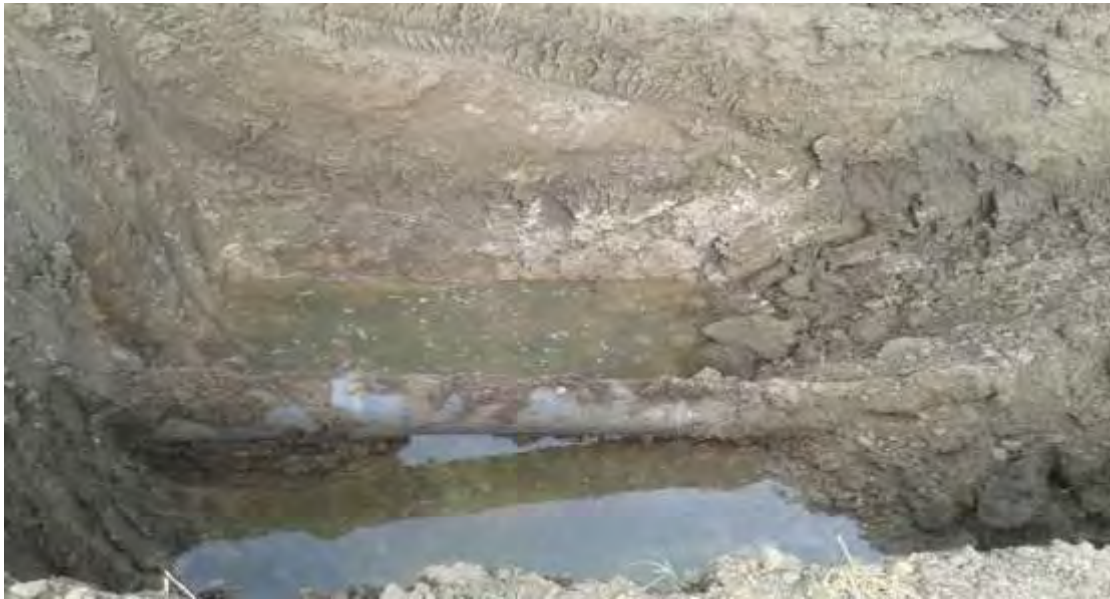
Εικόνα 5.22 βλαβη 10η διαρρηξη αγωγου στη ζώνη Σ2
