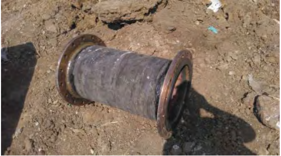
Εικόνα 5.33 βλάβη 7η διάρρηξη αγωγού στη ζώνη Σ4
