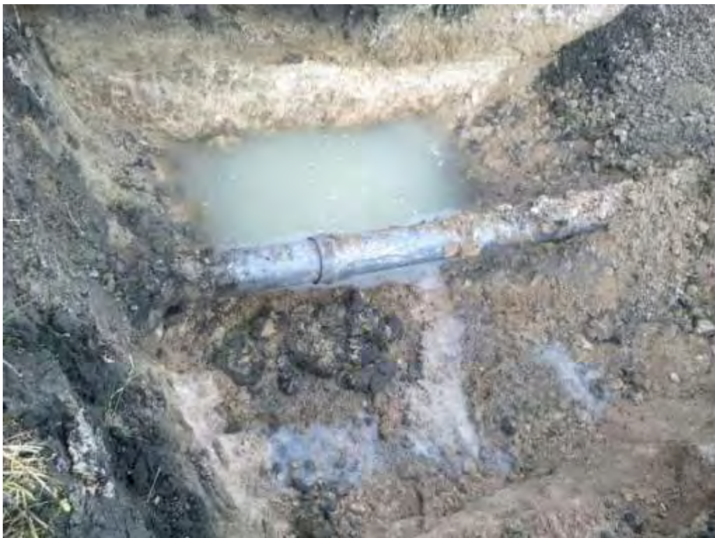
Εικόνα 5.7 βλαβη 7η διαρρηξη αγωγου στη ζώνη Σ3
