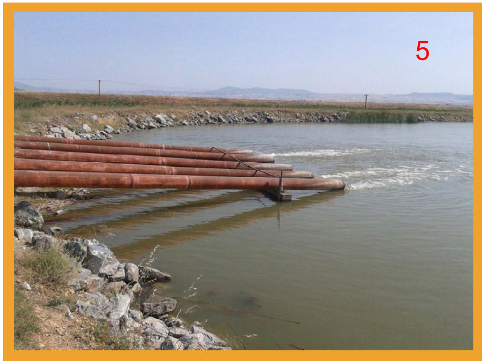
Εικόνα 4,5: Αντλιοστάσιο Ταμειυτήρα Καλαμακίου
