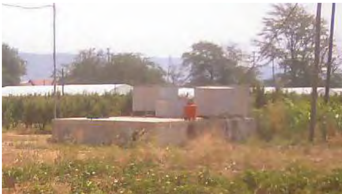
Εικόνα 3.6: Δεξαμενή με ειδικά διαμορφωμένα κουτιά που περιέχουν τον μηχανολογικό εξοπλισμό της άρδευσης.
