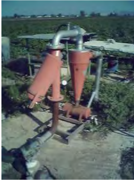
Φίλτρα καθαρισμού του νερού άρδευσης
