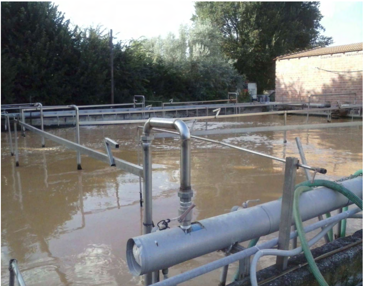
Εικόνα 2.1.1. Δεξαμενή συγκέντρωσης αποβλήτων της βιομηχανίας ΤΡΙΚΚΗ
