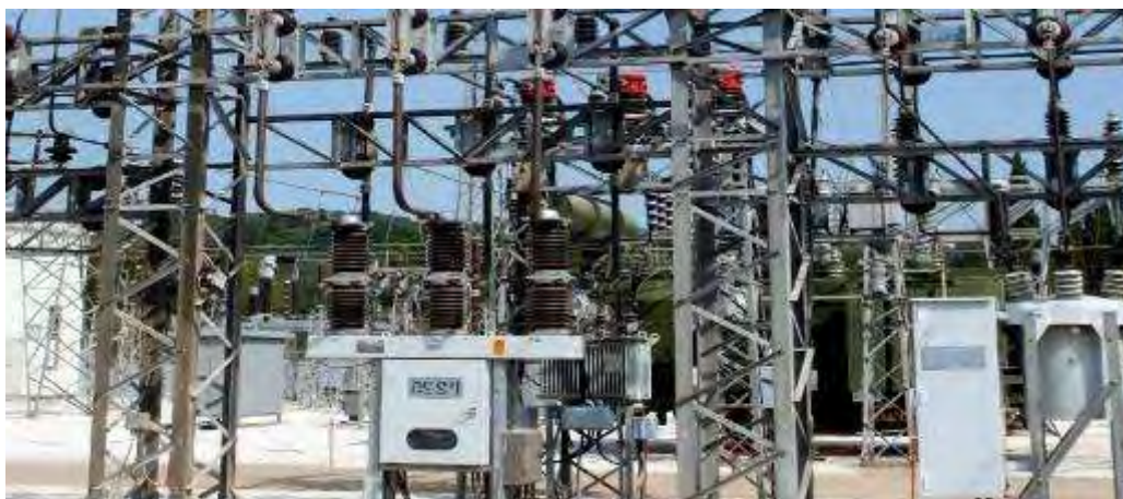
Εικόνα 1.2:Κέντρο Υπερυψηλής Τάσης
