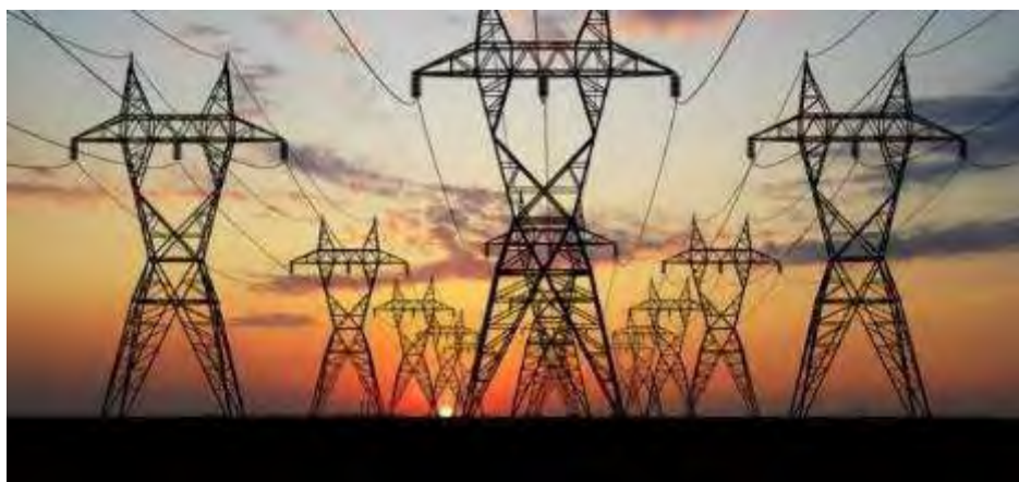
Εικόνα 1.3:Γραμμές Υψηλής Τάσης
