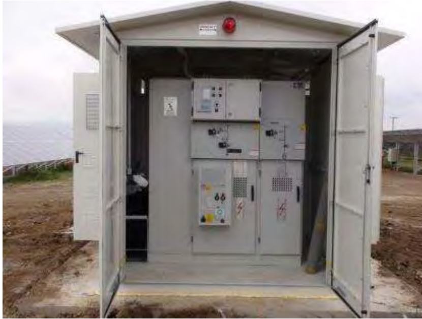
Εικόνα 1.1:Υποσταθμός Μέσης Τάσης
