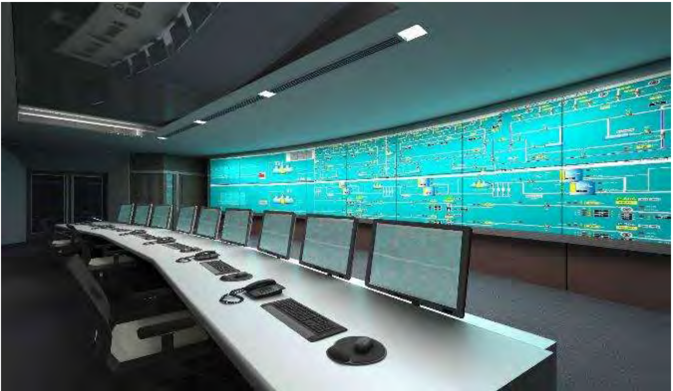
Εικόνα 2.5: Κέντρο Ελέγχου Συστήματος SCADA
