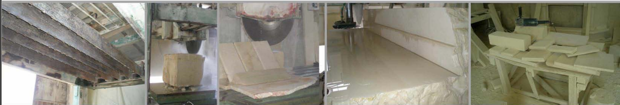
Διάφορα μηχανήματα επεξεργασίας της πέτρας (κόψιμο και γυάλισμα) και χειροκίνητα εργαλεία επεξεργασίας επιφανειών.
