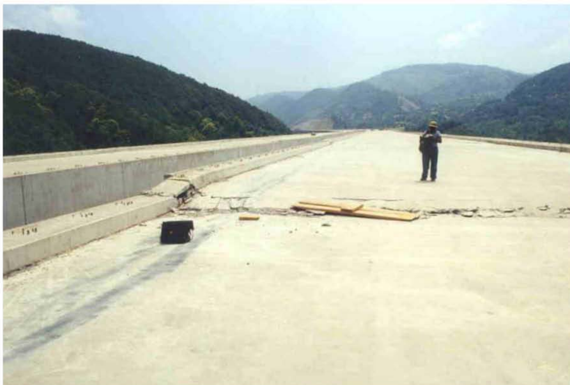
Εικόνα 1.1.3. Κατακόρυφη μετατόπιση 13,5 cm του νότιου καταστρώματος της Bolu Viaduct. ( www.engineering.purdue.edu/~anatolia/viaduct/research/report.html )
