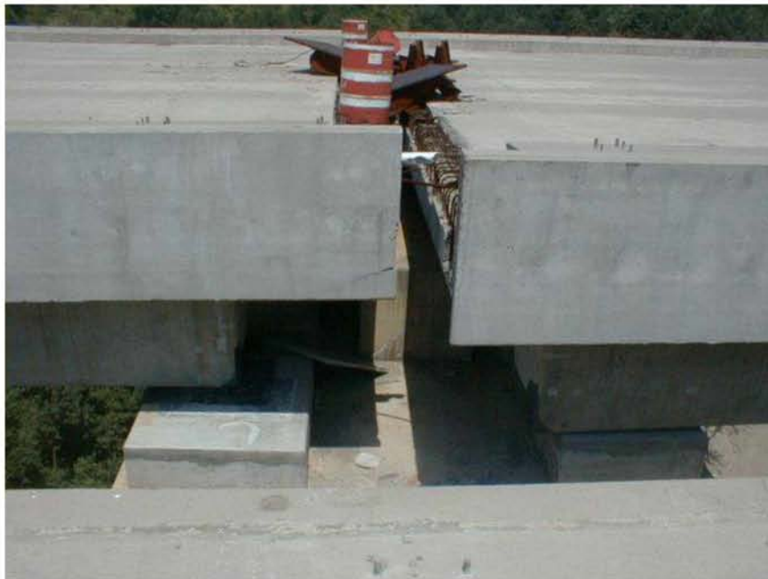
Εικόνα 1.1.2. Οριζόντια μετατόπιση του καταστρώματος της Bolu Viaduct στο βάθρο 10L. ( www.engineering.purdue.edu/~anatolia/viaduct/research/report.html )
