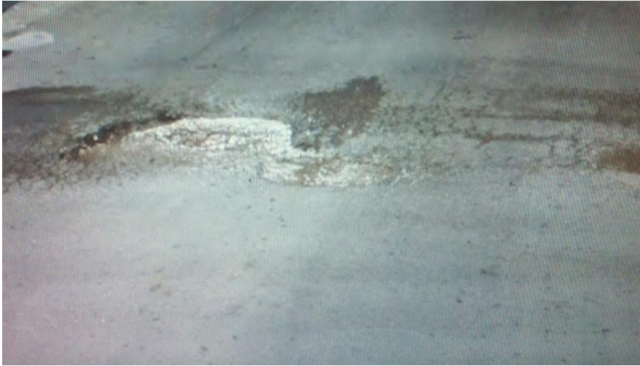
Εικόνα 7 : Ελλιπής συντήρηση οδοστρώματος
