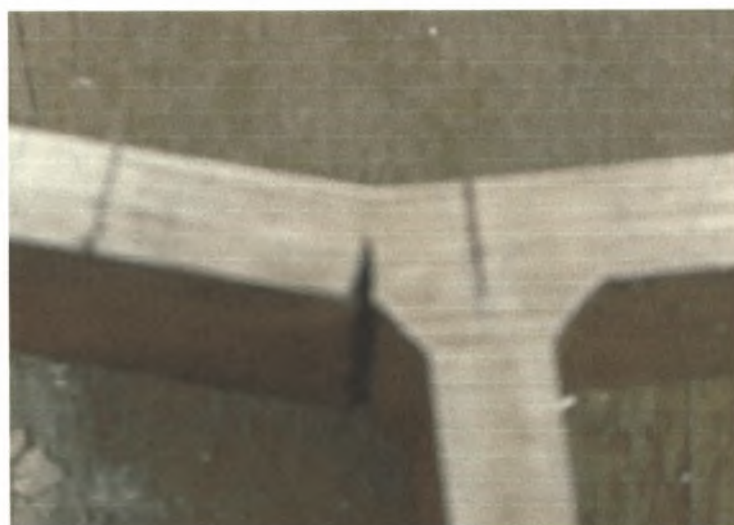
Σχήμα 3.4.2. Χαρακτηριστική ρωγμή που ξεκίνησε στη ρίζα της συγκόλλησης (κάτω σημείο διεπιφάνειας συγκόλλησης και μητρικού χάλυβα) παράλληλη με τη συγκόλληση.
