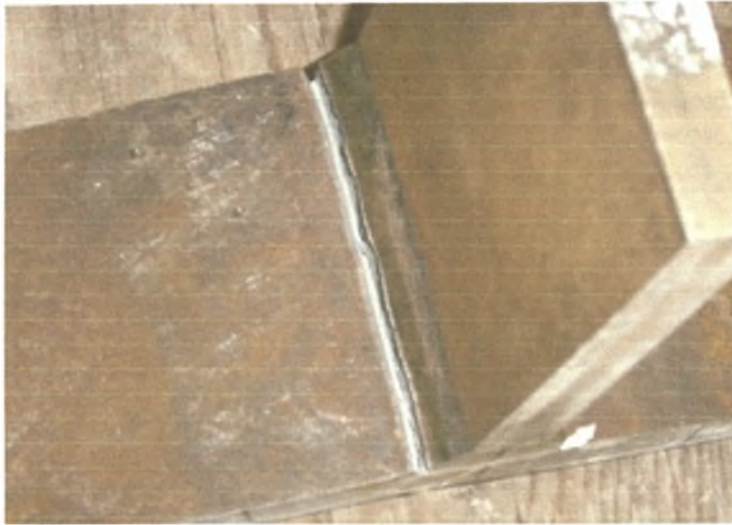
Σχήμα 3.4.3. Ανάπτυξη της ρωγμής κατά πλάτος της μεταλλικής πλάκας η οποία γίνεται εμφανής και στις δύο (2) παρειές.
